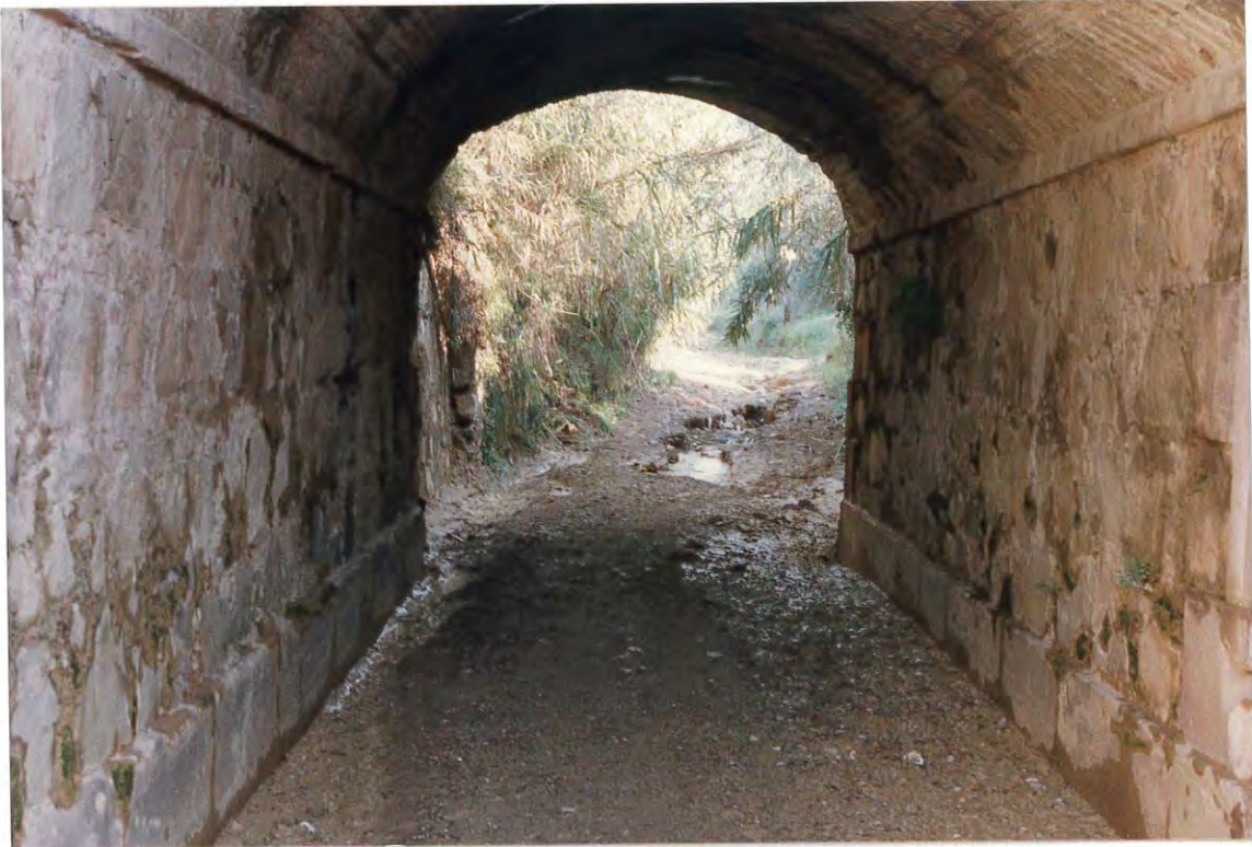
Figura 1. La riera Can Sant Tomàs a su paso bajo el ferrocarril. Se aprecia la erosión en el lecho provocada por el agua.
