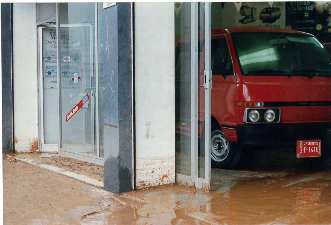
Figura 5. Local comercial situado en la carretera C-245, junto a la riera de Sant Llorenç.
