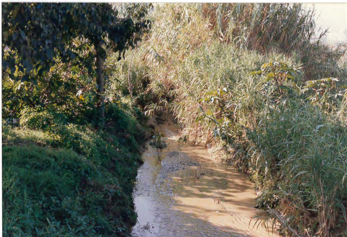
Figura 10. El cauce del Torrent d'en Benet a la salida del núcleo urbano, constituido por un canal de 0,90 x 1,50 m, cubierto de vegetación.
