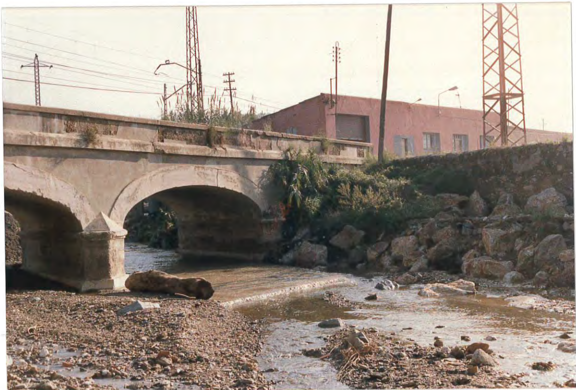
Figura 4. Taponamiento del vano izquierdo del puente de la carretera a Caldes de Montbui, visto desde aguas abajo.
