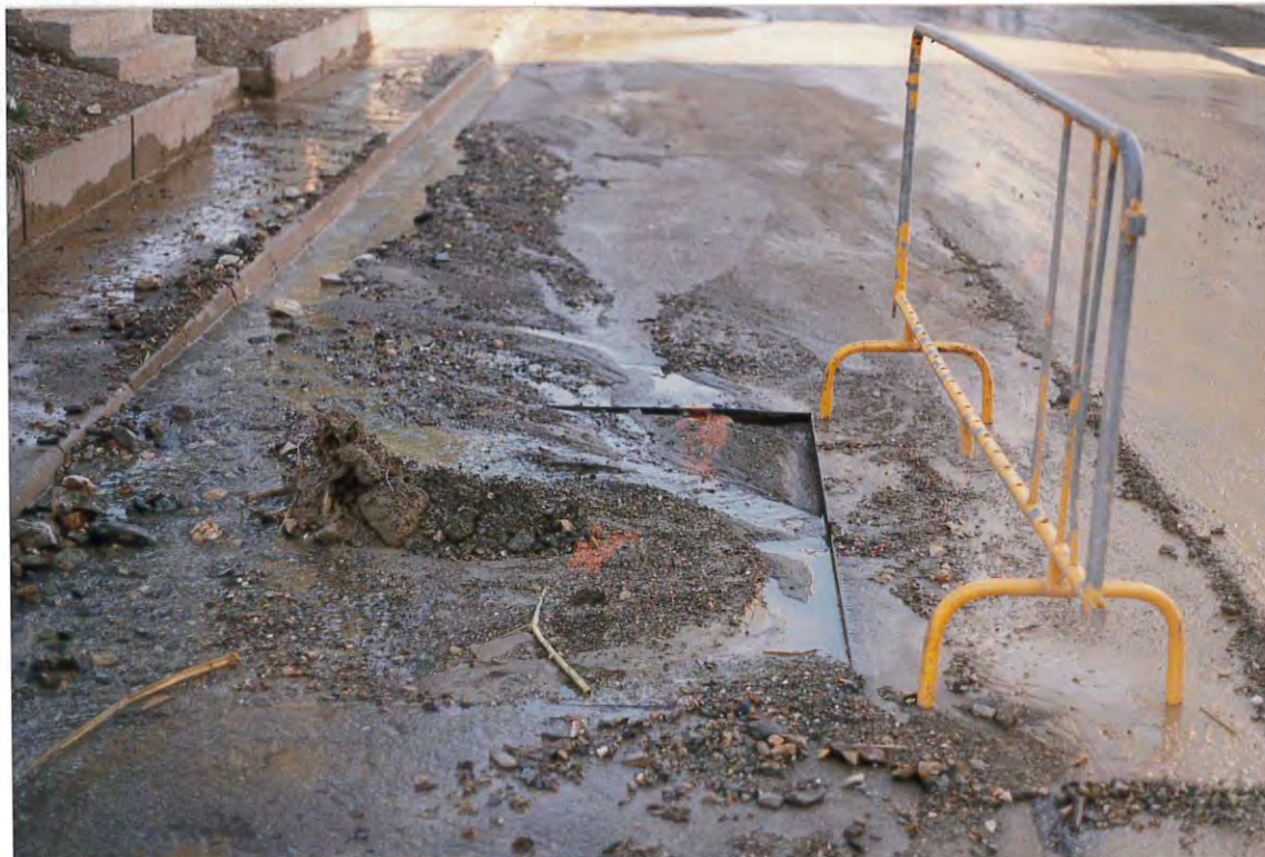
Figura 4. El alcantarillado, con una sección circular de 2 m, también quedó aterrado.
