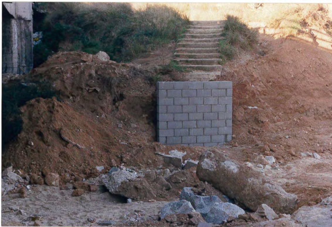
Figura 5. El agua arrastró un pequeño puente de peatones situado bajo el paso de la autopista A-19.
