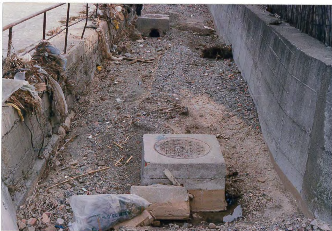
Figura 4. Arrastres acumulados en el lecho del torrent Tapioles, y altura alcanzada por las aguas (90 cm).
