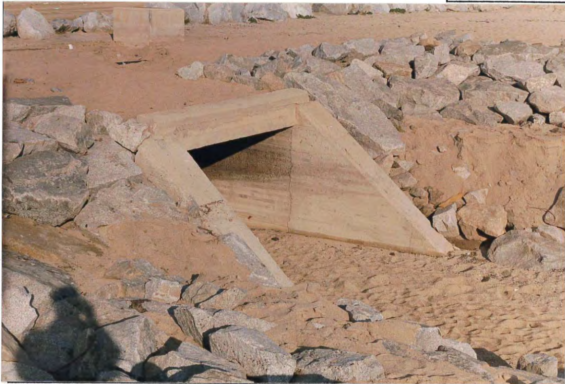
Figura 1. Desagüe al mar en las playas de Badalona. Aunque puede apreciarse un ligero aterramiento del lecho, su funcionamiento fué correcto.
