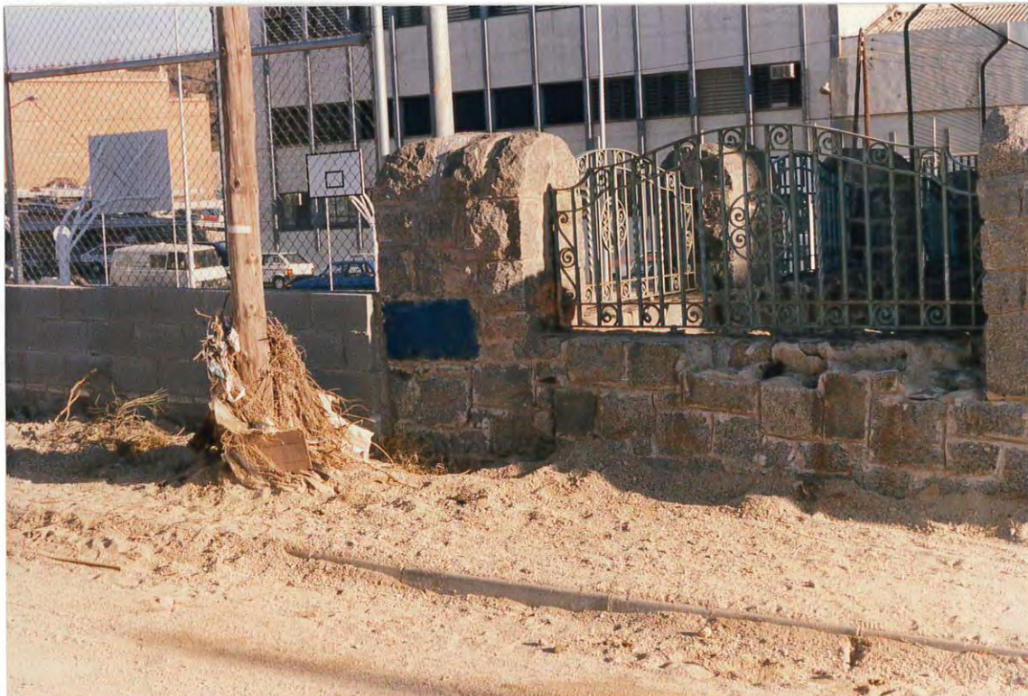
Figura 10. Detalle de los arrastres acumulados y de la rotura de uno de los muros.
