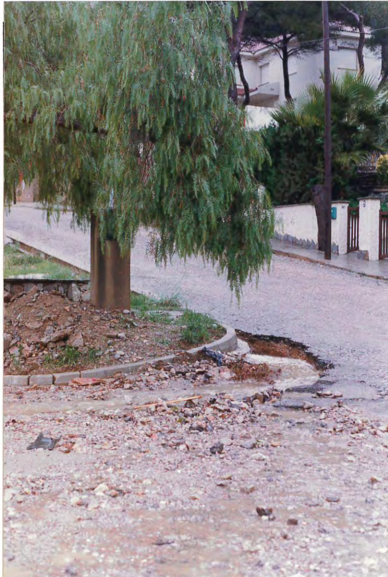
Figura 4. Detalle de la erosión producida por las aguas en la confluencia del paseo de Can Viñas y la avenida de Bellamar.
