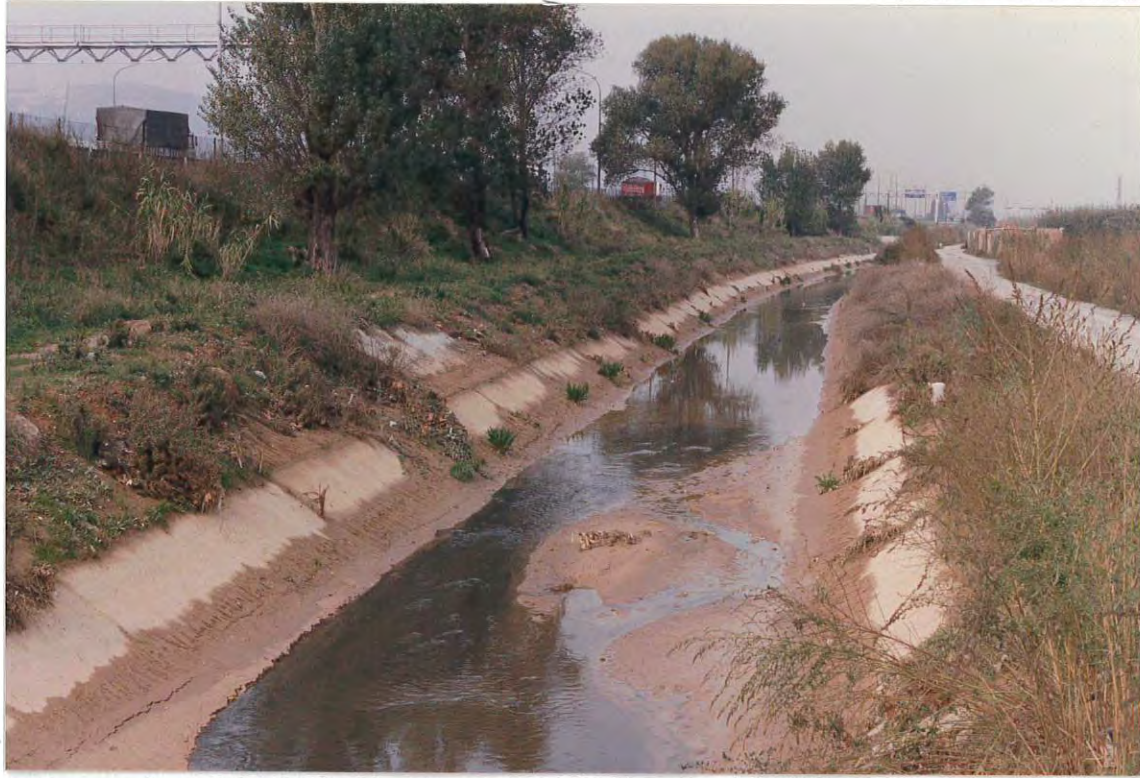
Figura 1. La capacidad del canal, incluso en la zona más amplia, es insuficiente para desaguar los caudales que le llegan.
