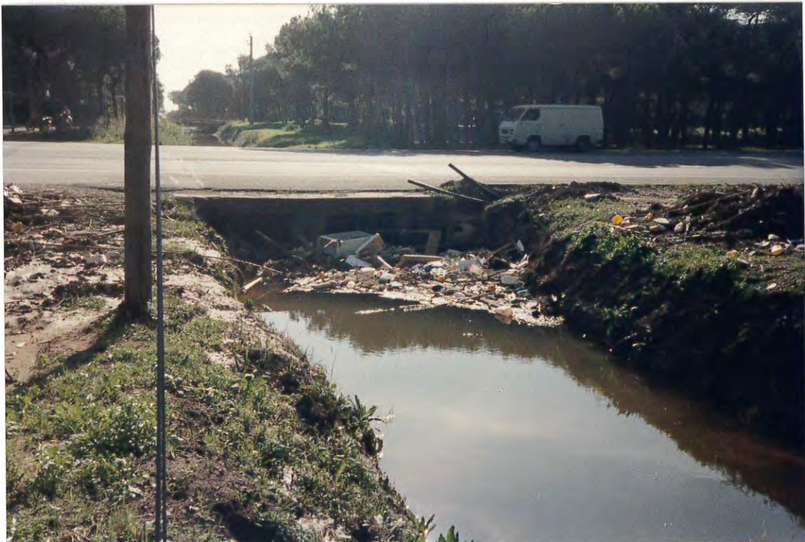
Figura 2. Paso de la riera bajo la Autovía de Castelldefels, con la basura retenida en el obstáculo que crea la pila central.
