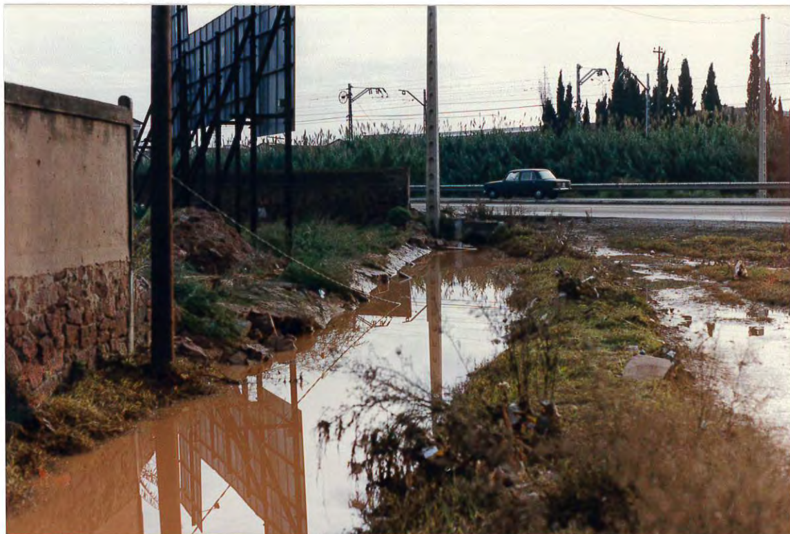
Figura 2. Tubo de desagüe que cruza la carretera C-245, totalmente insuficiente. A la izquierda, muro derribado por el agua.
