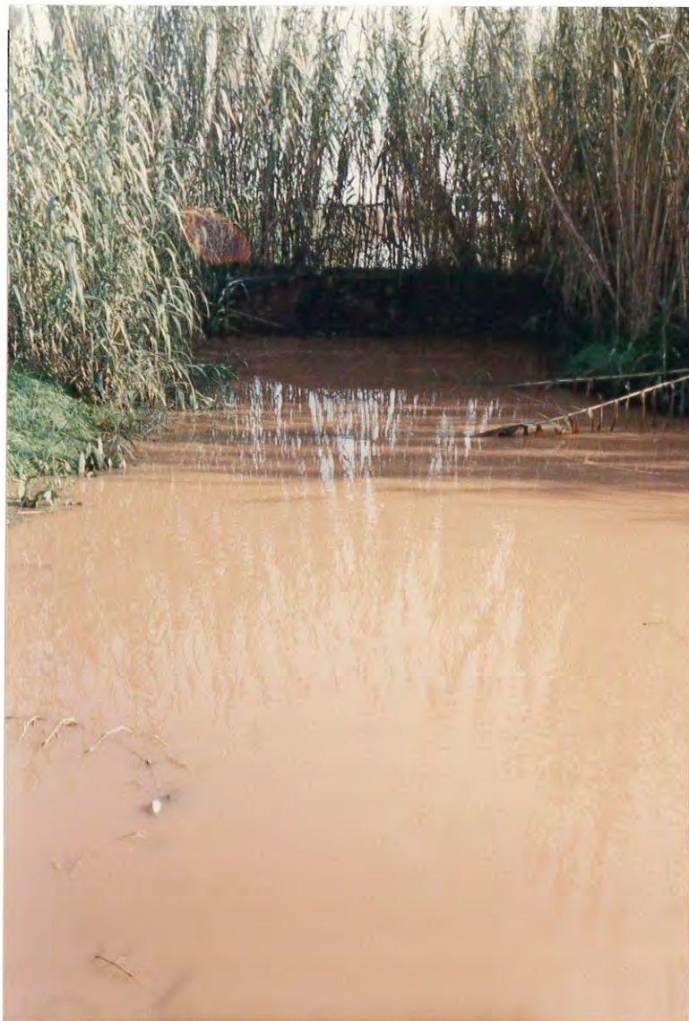
Figura 2. Corredera Principal, aguas abajo de la calle Bertràn i Güell, donde existe un antiguo puente que dificulta enormemente el paso del agua.
