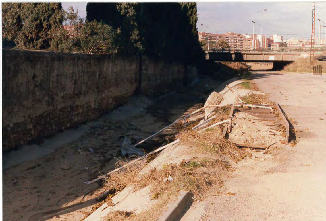
Figura 6. La losa del puente arrastrada hasta el centro del cauce de la riera.
