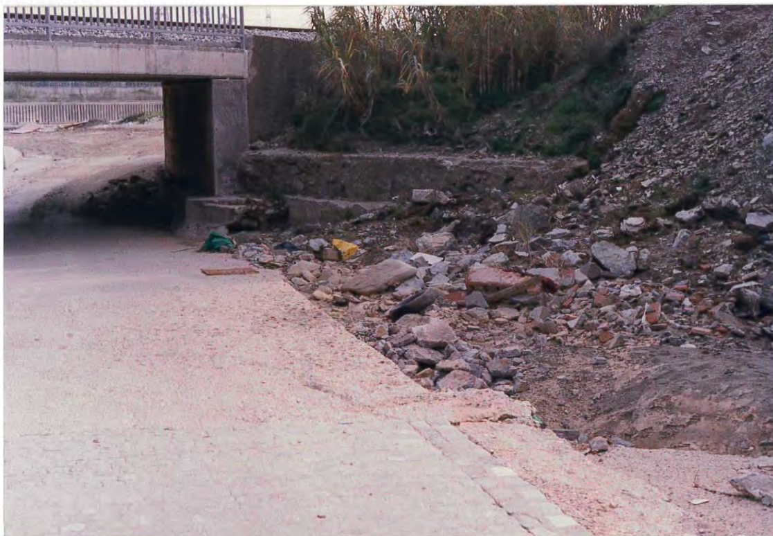
Figura 6. Erosión y arrastres acumulados en el margen derecho del torrent Tapioles.
