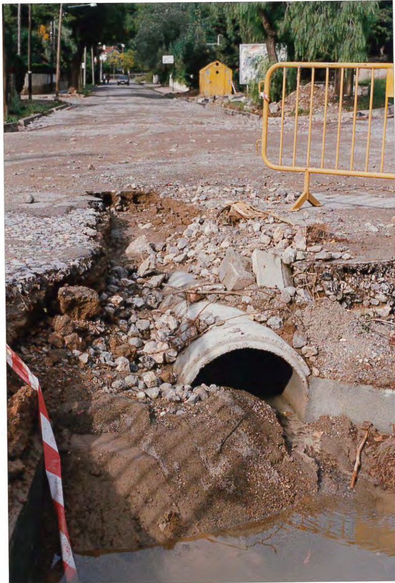
Figura 3. Aspecto de la avenida de Bellamar tras el episodio de lluvias.
