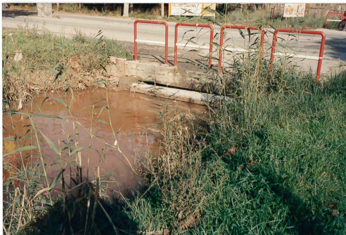
Figura 2. Puente sobre la Corredera Maestra sobre la Av. de la Pineda, donde se aprecia una conducción de agua potable que disminuye la sección.
