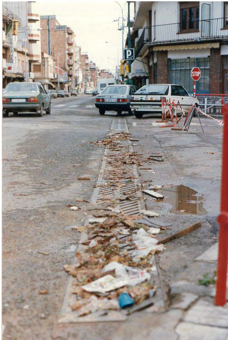
Figura 3. Arrastres acumulados en la rejilla de protección del paso inferior de la Avenida de la Pineda.
