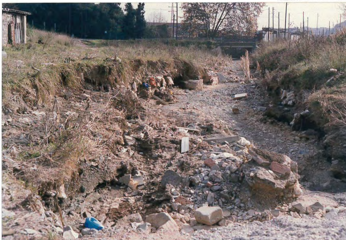
Figura 1. Estado en que quedó el cauce del torrent Tapioles, tras su paso bajo la carretera N-152.
