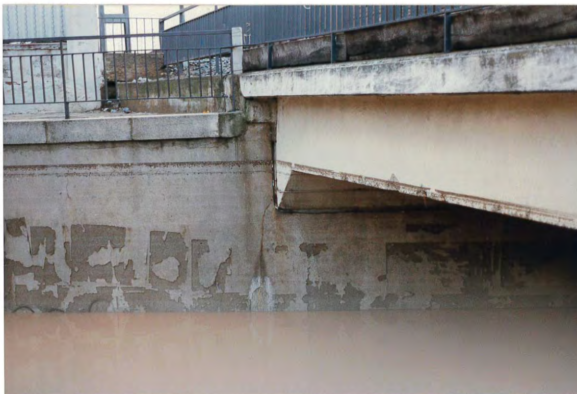
Figura 2. Detalle del puente en el que se aprecian los 4,5 m de altura alcanzados por el agua.
