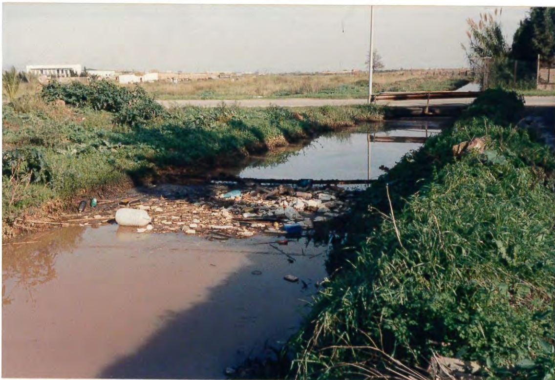
Figura 4. Detalle de la basura acumulada aguas arriba de una pequeña conducción de agua en la riera de les Parets.
