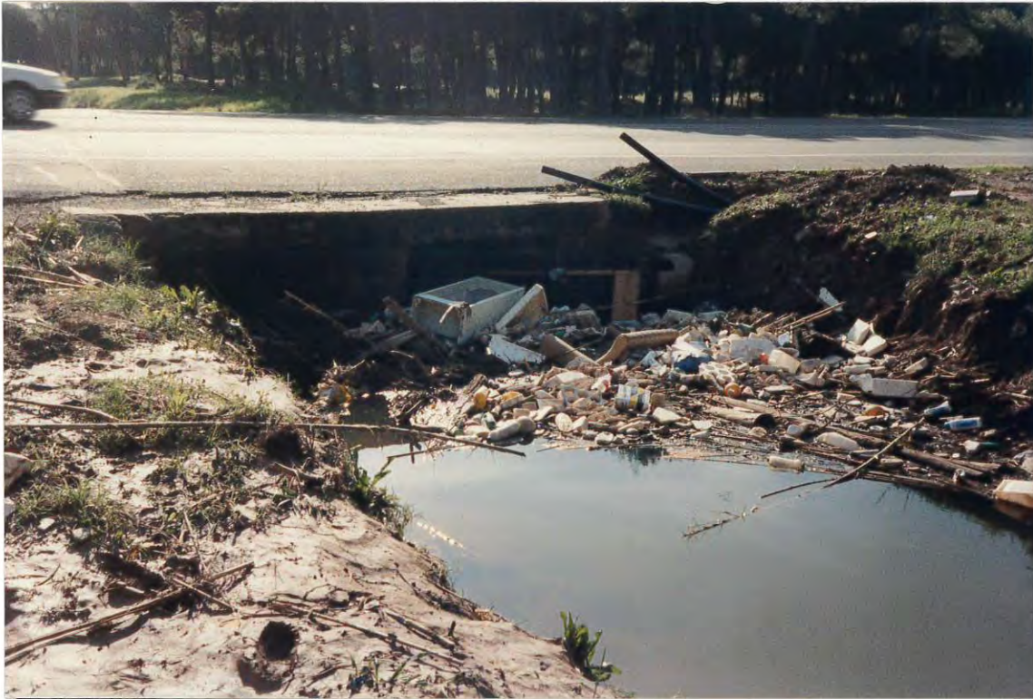
Figura 3. Detalle de la basura retenida aguas arriba del paso de la riera bajo la Autovía de Castelldefels.
