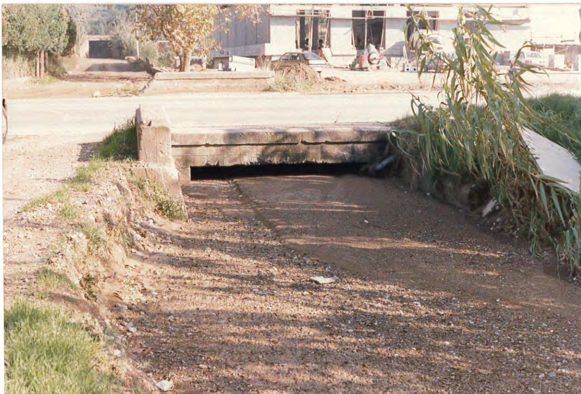
Figura 2. Cauce de la riera Can Paissa a su paso bajo la carretera nacional N-II, visto desde aguas abajo.
