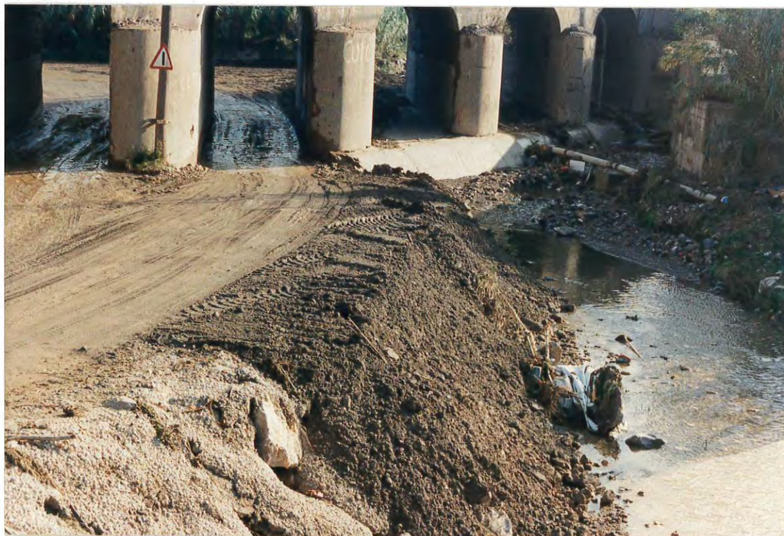
Figura 2. Reducción ostensible de la sección de la riera de Vallvidrera para permitir el paso de vehículos.
