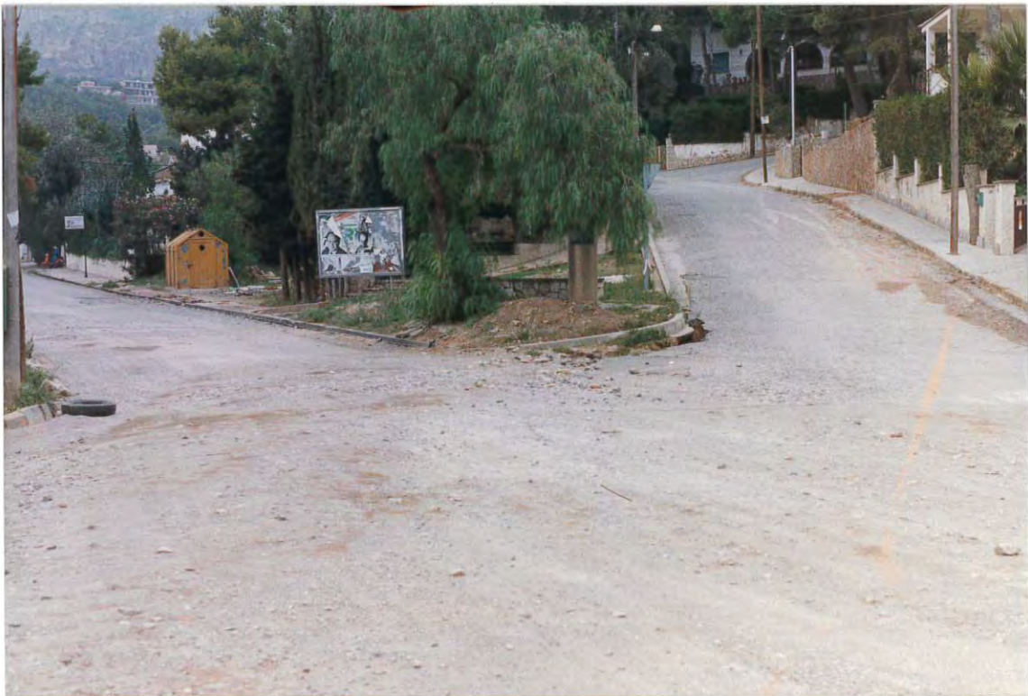
Figura 2. Confluencia del paseo de Can Viñas con la avenida de Bellamar donde puede observarse la erosión producida en la zona de máxima pendiente.
