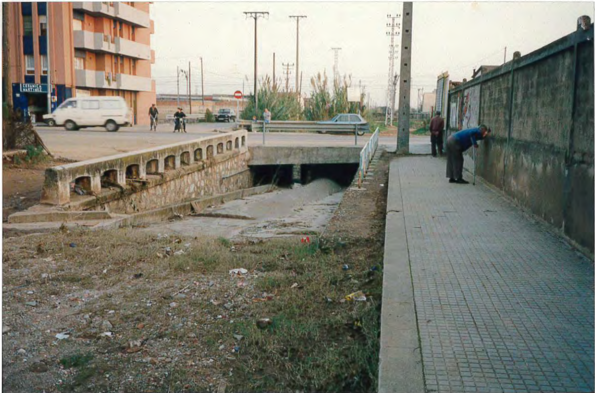
Figura 1. Paso de la riera de les Parets bajo la carretera C-245. El nivel de agua sobrepasó la cota de la calzada, inundando las zonas colindantes.
