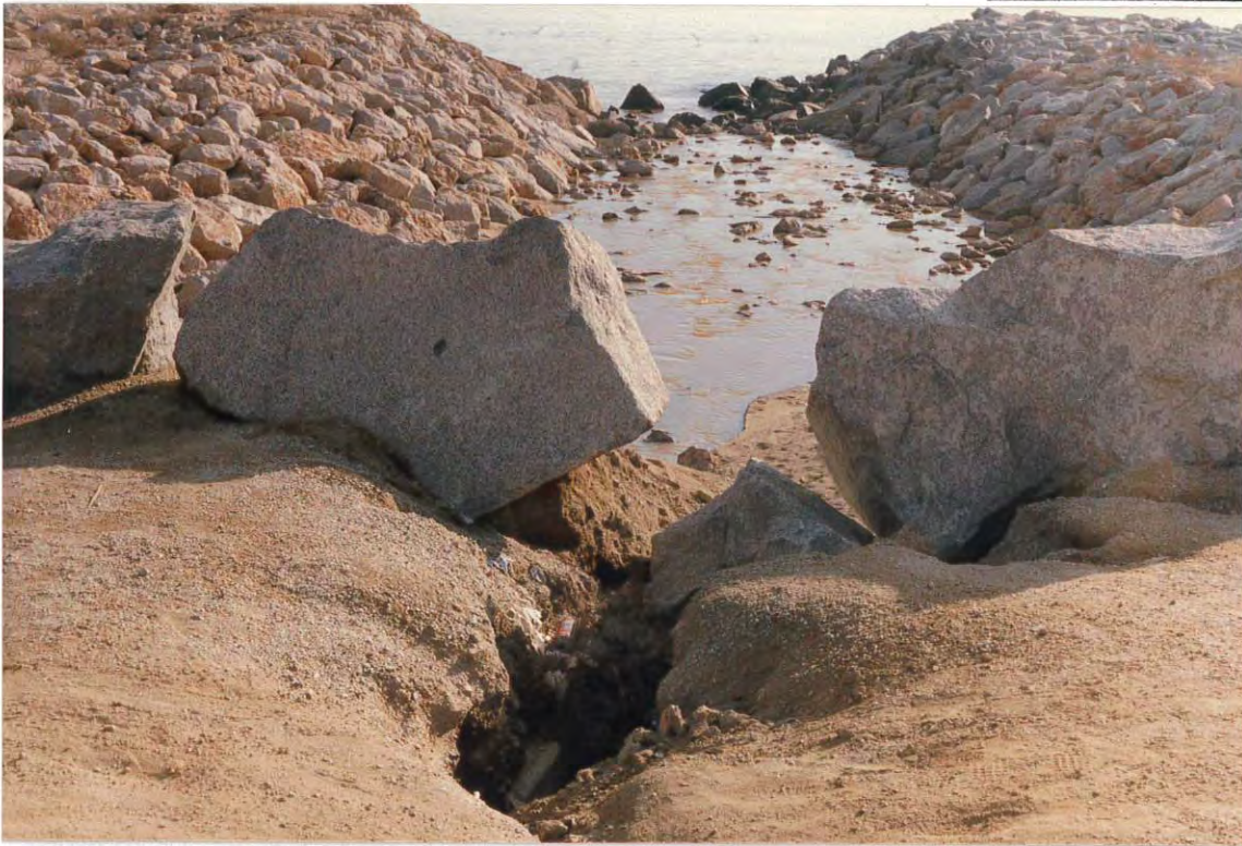
Figura 3. Erosión producida en zonas anteriores a la escollera de protección.
