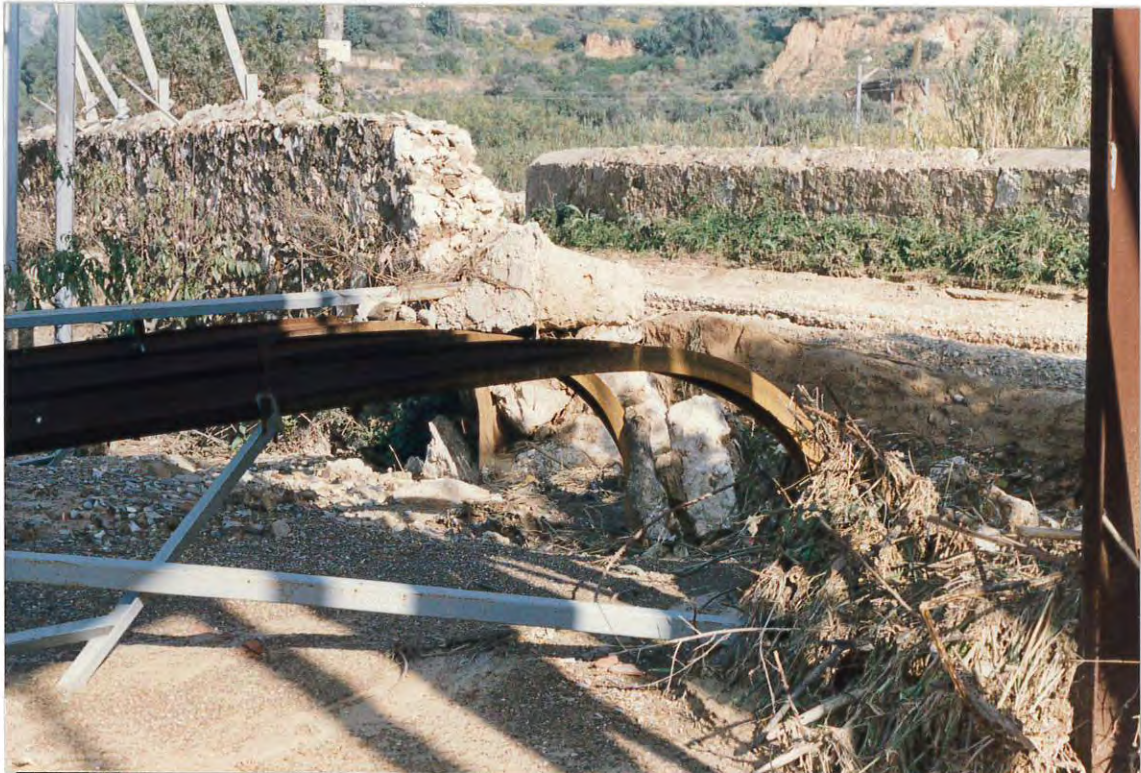
Figura 2. Muro de contención caído justo tras la pronunciada curva del cauce de la riera.
