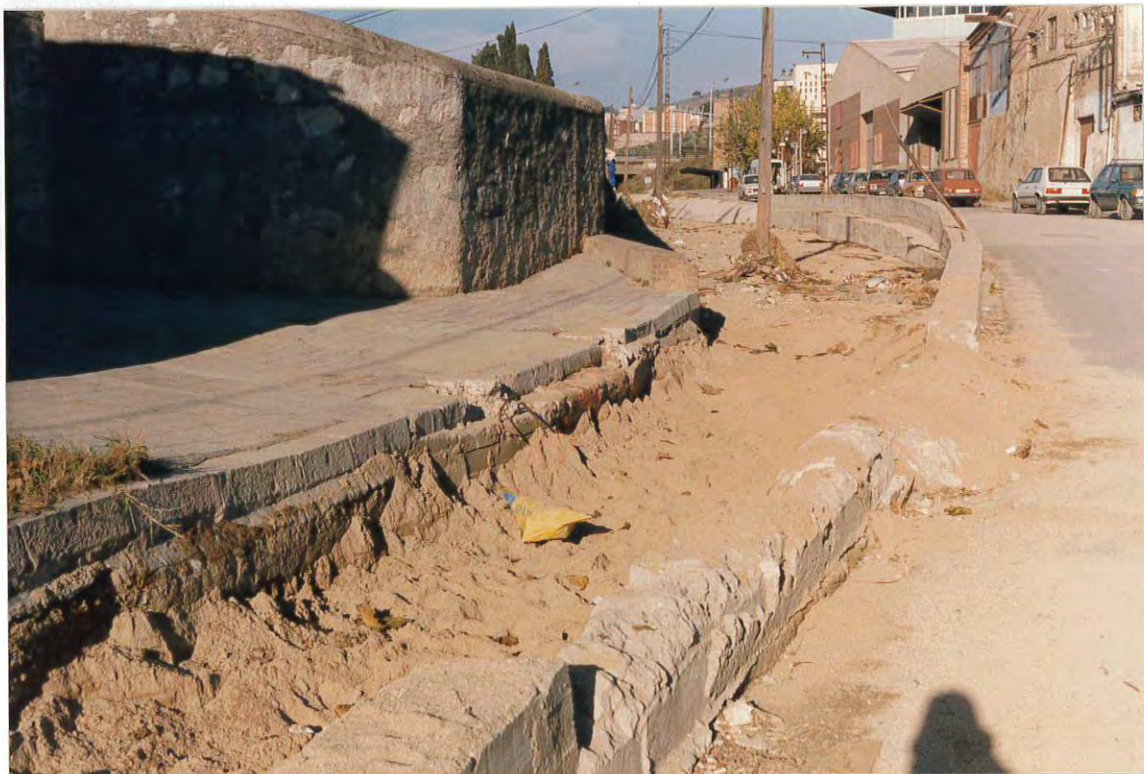
Figura 8. Reducción considerable de la sección hidráulica de la riera de Canyadó tras su paso bajo la autopista A-19.
