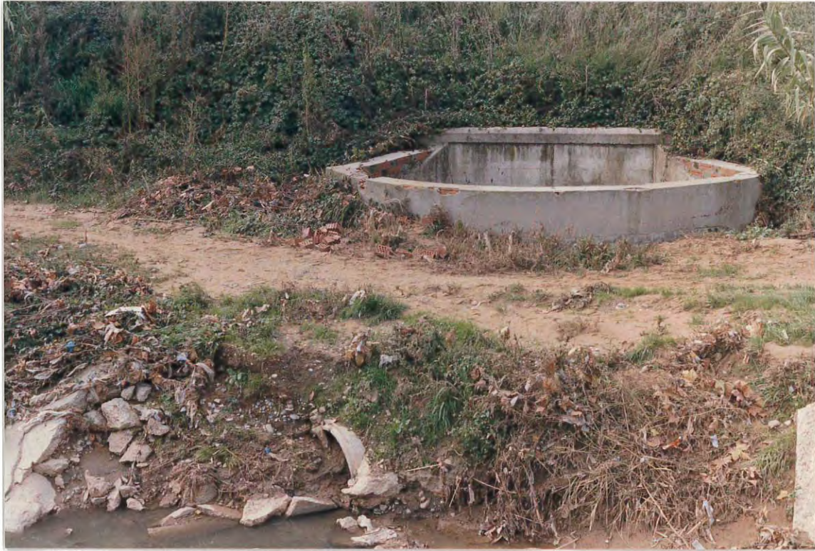
Figura 3. Taponamiento de uno de los desagües, y muestra patente de la falta de protección del margen.
