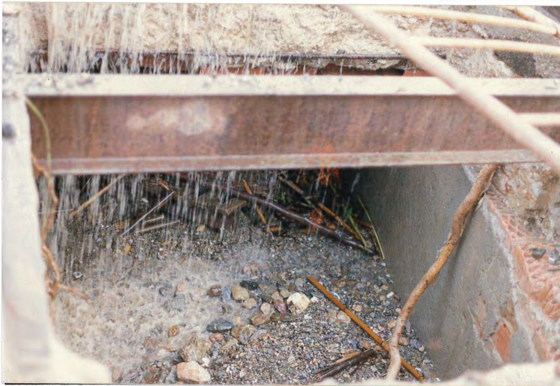
Figura 5. Detalle de los arrastres acumulados en el interior de alcantarillado, con sección circular de 2 m de diámetro.
