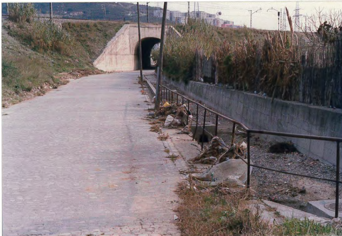
Figura 3. Desaparición progresiva de la sección hidráulica del torrent Tapioles.
