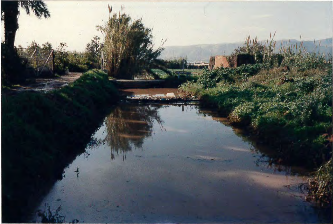
Figura 3. Puente en estado ruinoso en la riera de les Parets, aguas arriba de la calle Bertràn i Güell.
