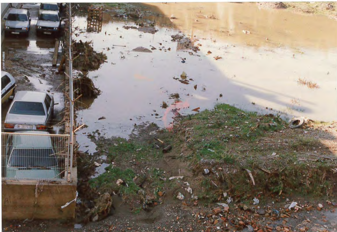
Figura 3. Rotura del margen derecho del encauzamiento del Torrent Tapioles, debido a las retenciones causadas por la insuficiente capacidad de desagüe de los tubos.
