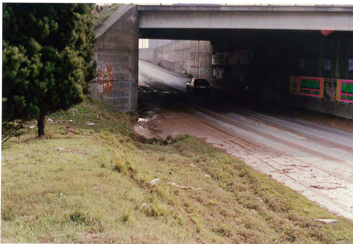
Figura 5. Acceso a El Prat de Llobregat bajo el puente de la Autovía de Castelldefels. El agua del río entró por el desagüe situado en la base del estribo izquierdo.
