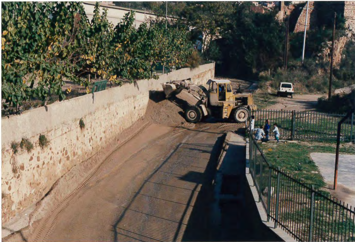
Figura 1. Trabajos de limpieza de la arena acumulada en el cauce de la riera de Tiana, donde puede apreciarse como el agua sobrepasó la acera lateral.
