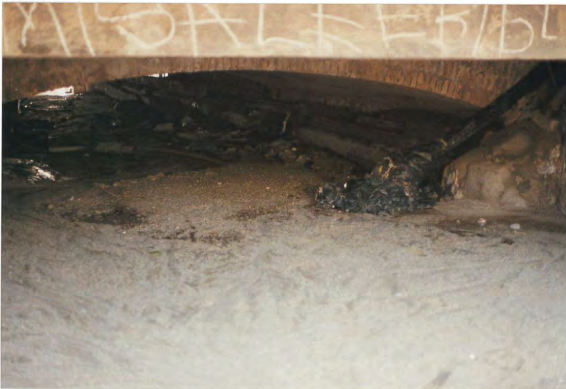
Figura 6. La riera de Tiana a su paso bajo los puentes de la carretera nacional N-II y del ferrocarril, donde pueden apreciarse la gran cantidad de arrastres producidos.
