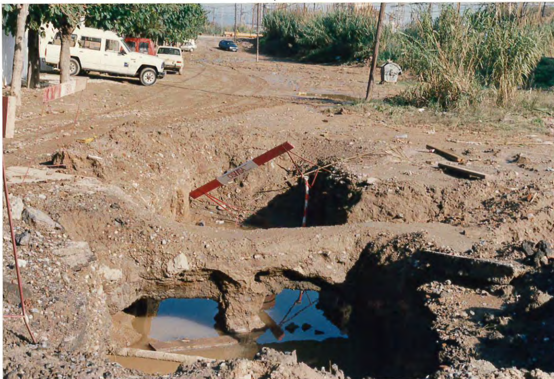
Figura 3. Rotura producida al entrar en carga el alcantarillado.
