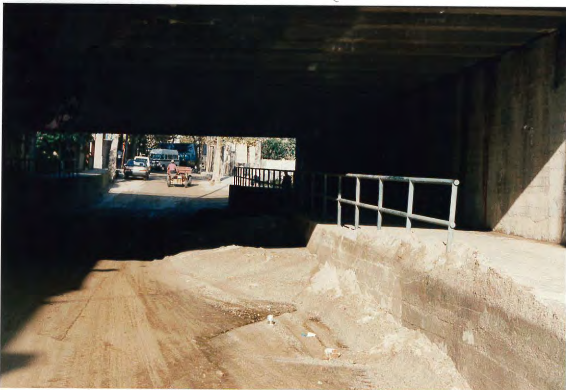
Figura 4. Arrastres acumulados en la riera de Tiana a su paso bajo la autopista A-19.
