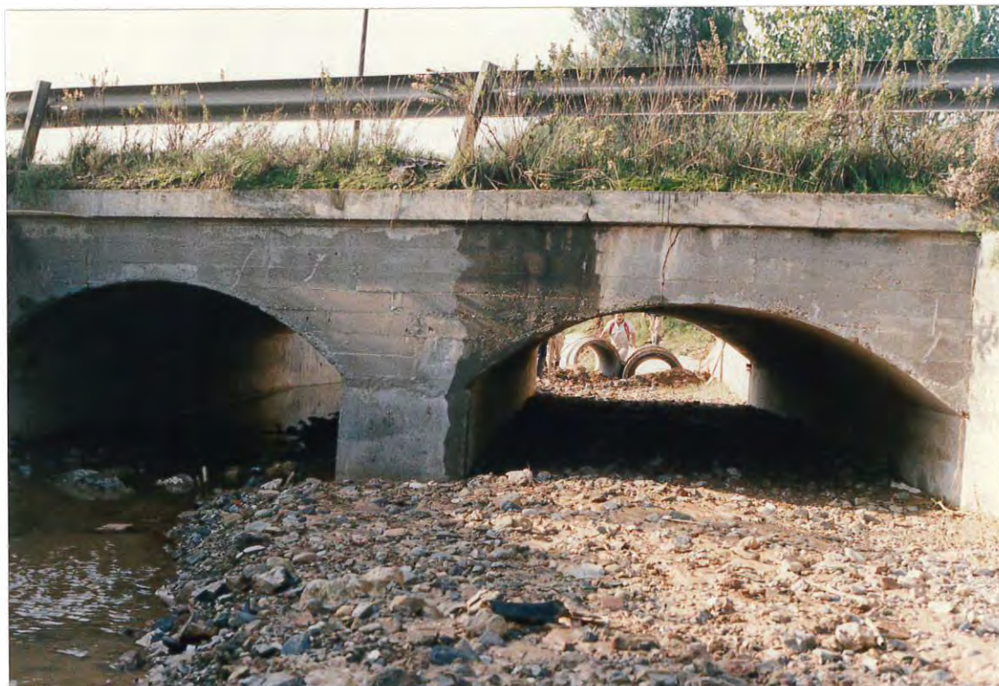
Figura 6. El Torrent Batsacs a su paso bajo la carretera C-1412, en el que se aprecian los arrastres acumulados, especialmente en el ojo derecho.
