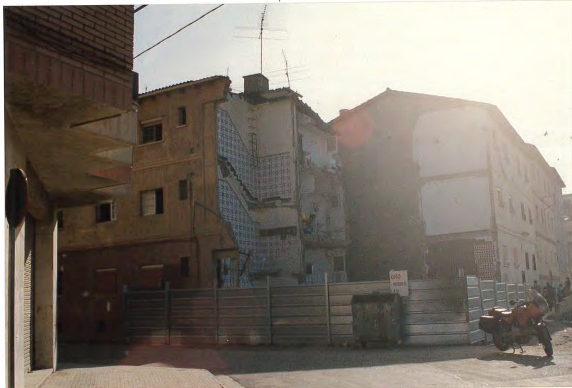
Figura 3. Restos del edificio situado junto a la riera Guinovart, que se derrumbó como consecuencia de las lluvias.
