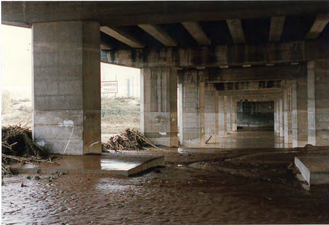
Figura 7. Puente nuevo de la Autovía de Castelldefels sobre el río Llobregat, donde puede observarse el nivel alcanzado por las aguas.
