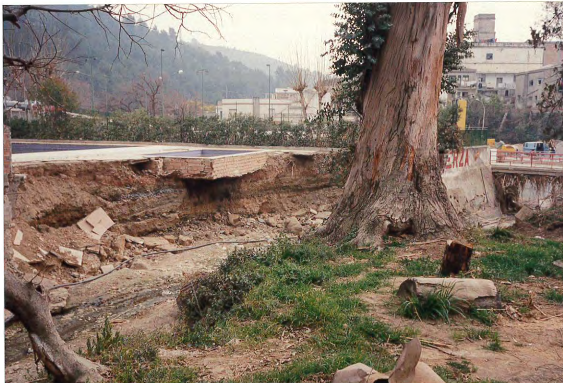
Figura 3. Estado en que quedaron unas piscinas situadas en las cercanías del cauce de la riera de Sant Climent.
