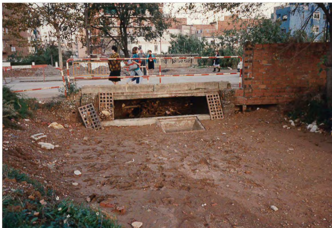
Figura 2. Entrada para visitar el tramo enterrado de riera, donde pueden verse los arrastres acumulados en el interior de la conducción.
