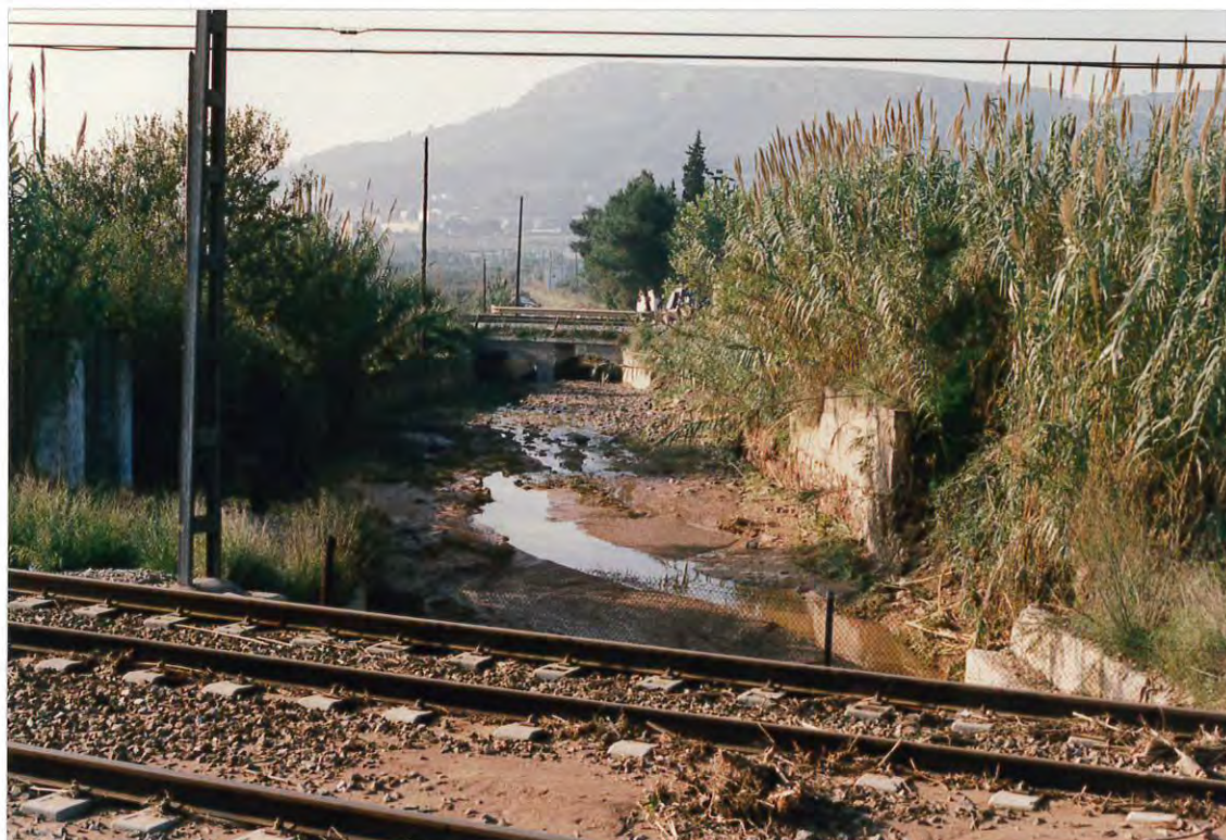
Figura 4. El Torrent Batsacs a su paso bajo la carretera C-1412. En primer término, arrastres acumulados sobre el balasto.
