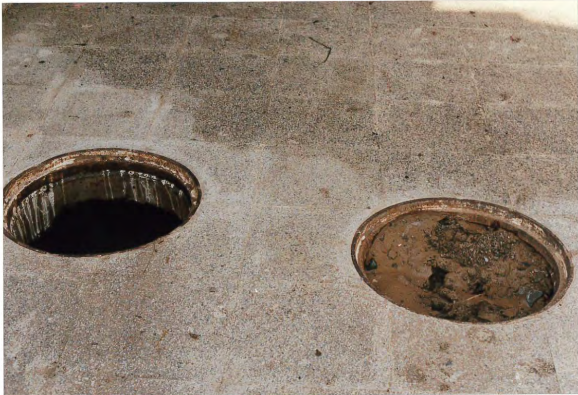
Figura 3. Sección del alcantarillado que discurre bajo la riera d'en Font y que quedó aterrado.
