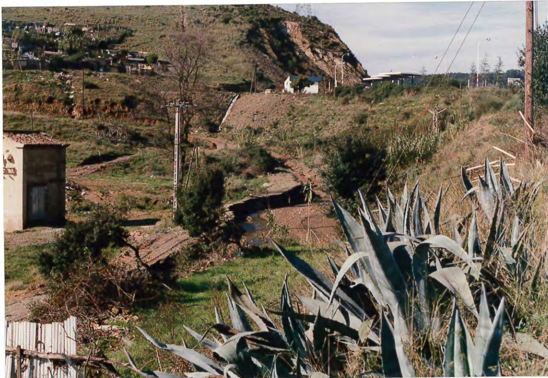
Figura 1. Erosión del margen derecho del Torrent Tapioles, a su entrada al Polígono Industrial Can Cuyàs.
