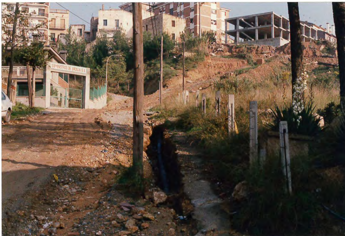
Figura 3. Descalzamiento del alcantarillado.
