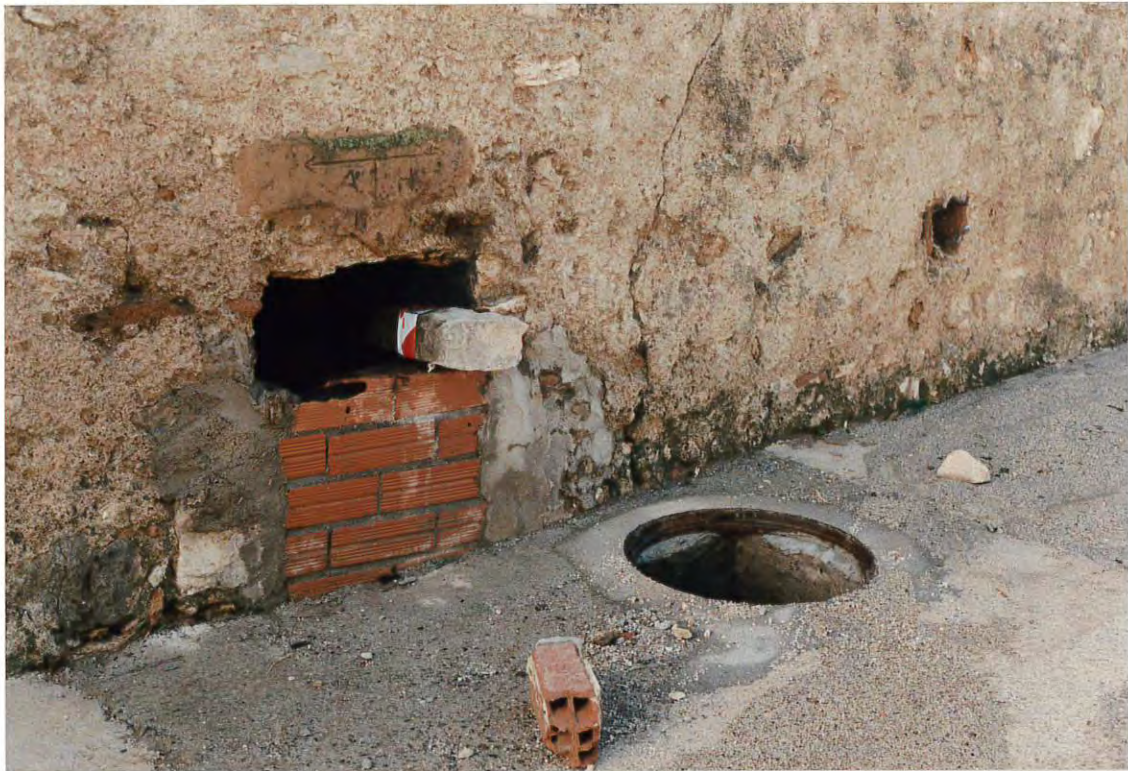
Figura 3. Agujero producido al entrar en carga el alcantarillado, frente a un colegio público.
