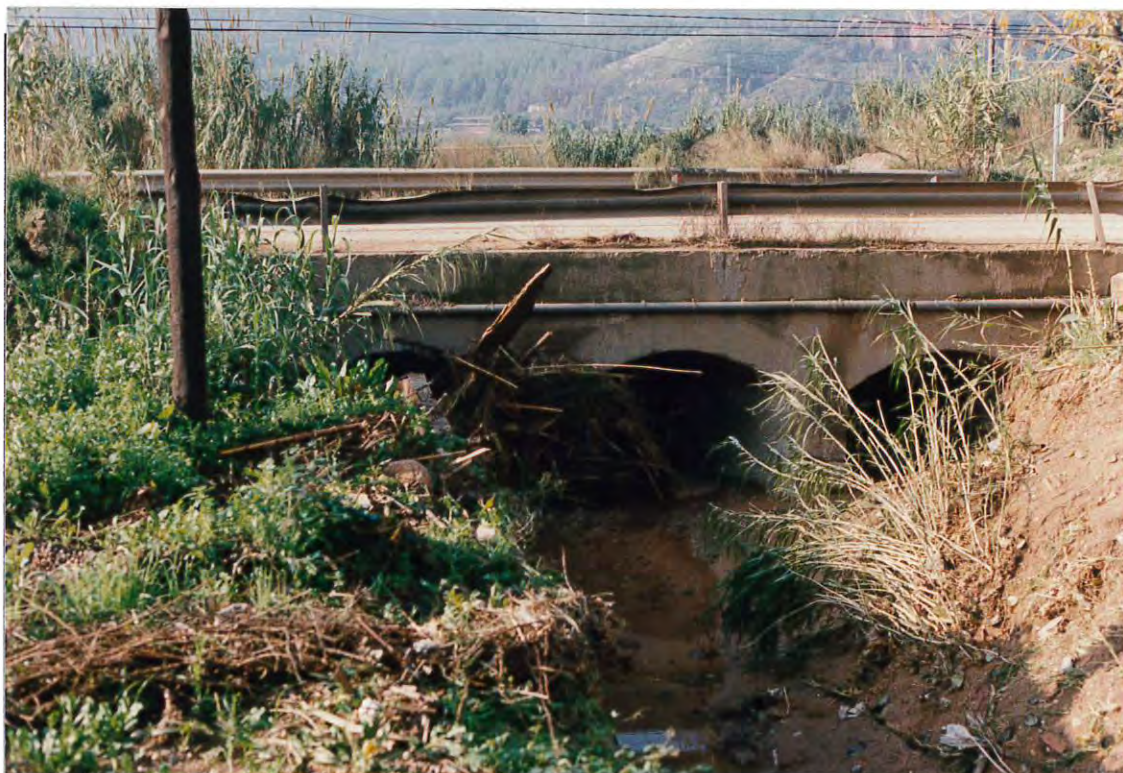
Figura 2. Arrastres acumulados en el cauce del Torrent Batsacs a su paso bajo el puente de la carretera a Sabadell.
