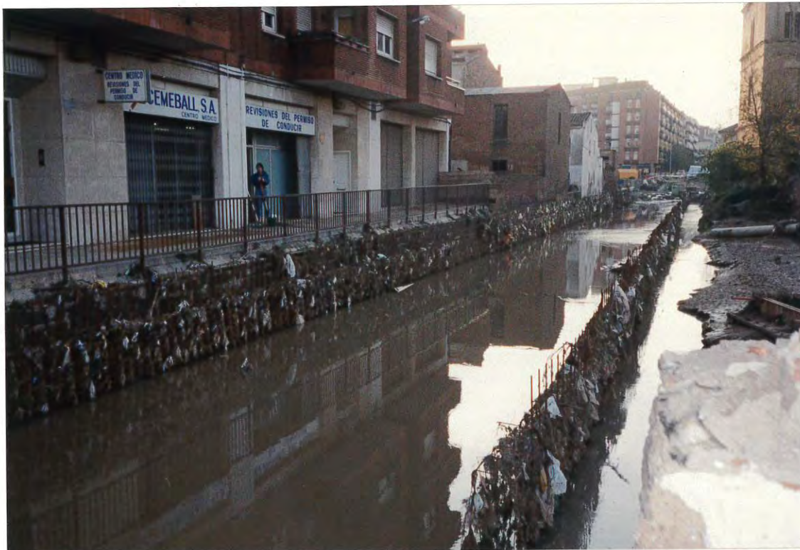
Figura 1. Nivel alcanzado por las aguas en los hastiales del encauzamiento en obras y en los edificios colindantes.
