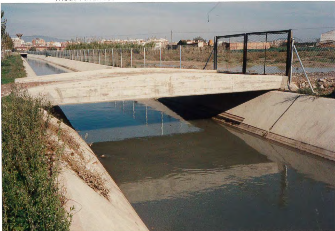
Figura 2. Nivel alcanzado por el agua en el canal de la Aviación.
