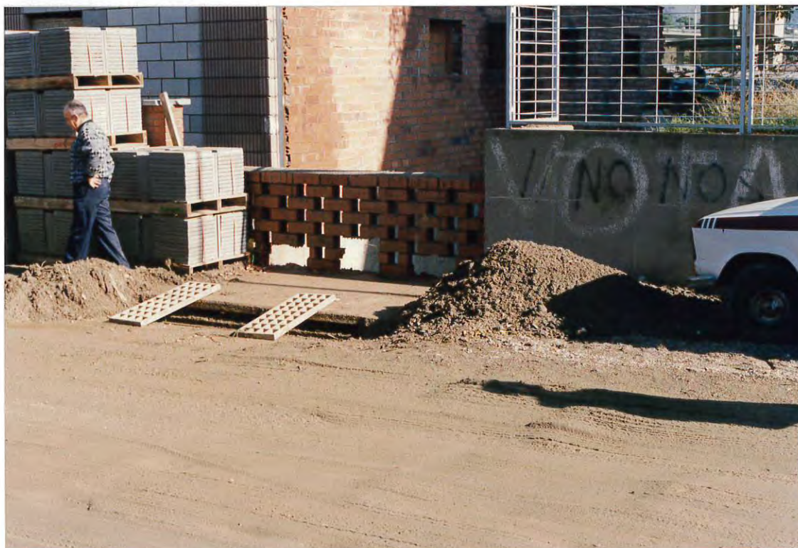
Figura 6. Limpieza de las rejillas de desagüe, y agujeros practicados en la verja para facilitar el desagüe.
