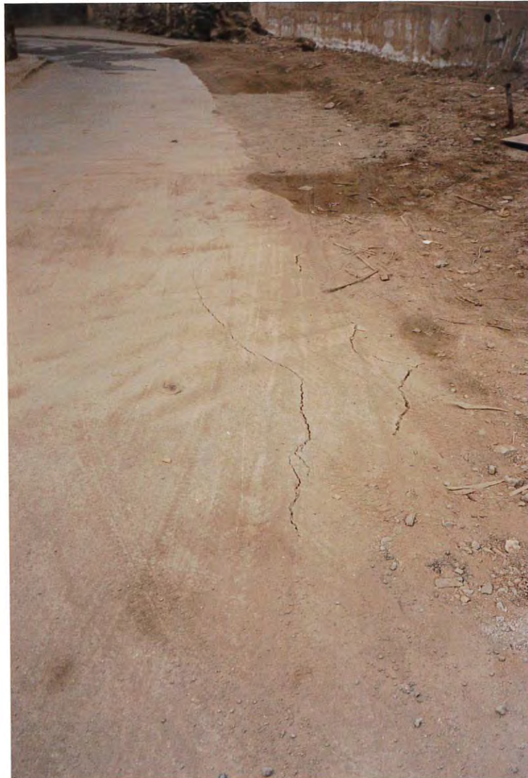
Figura 5. Grietas aparecidas en el pavimento de las calles cercanas al cauce de la riera de Sant Climent.
