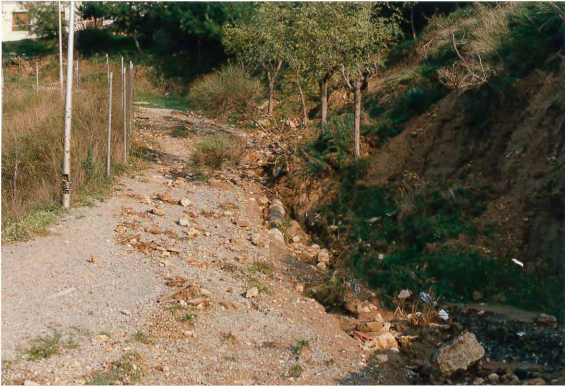
Figura 1. Desperfectos causados por el agua en la calle Brasil.
