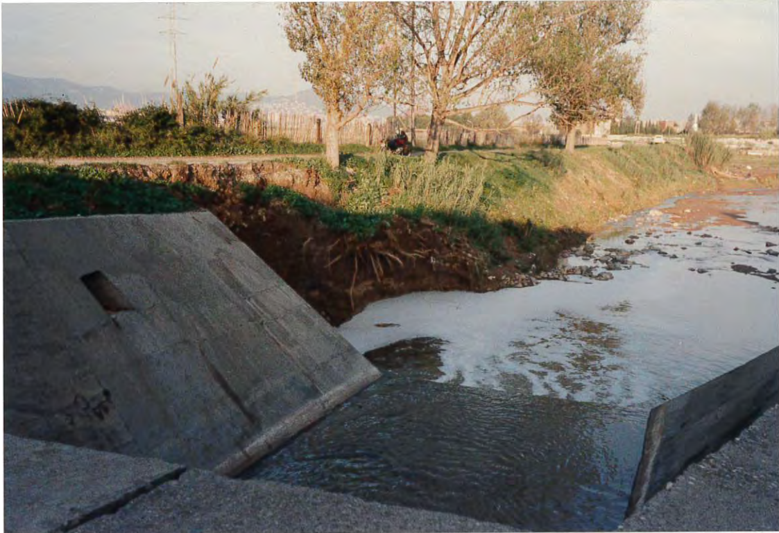
Figura 5. Desprendimiento en el tramo final del encauzamiento de la margen izquierda, donde puede apreciarse el escaso nivel alcanzado por las aguas.
