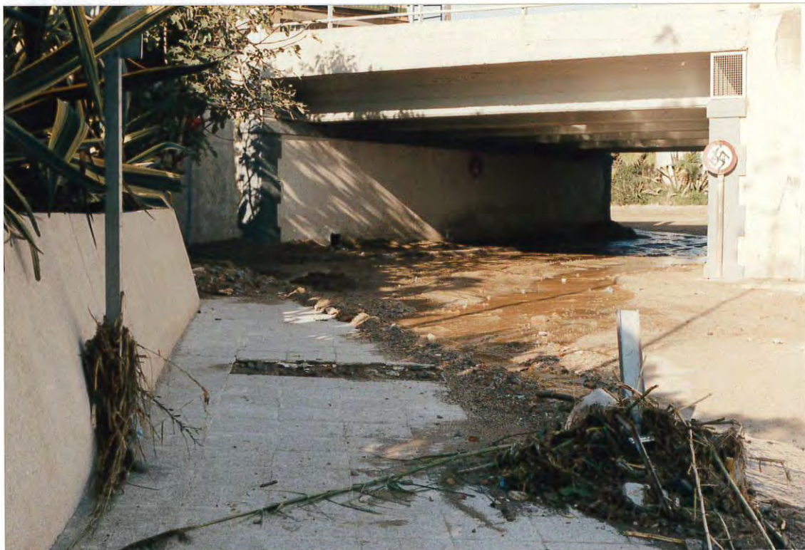
Figura 2. La riera d'en Font en su cruce con la carretera nacional N-II, donde el agua superó los 60 cm de altura.
