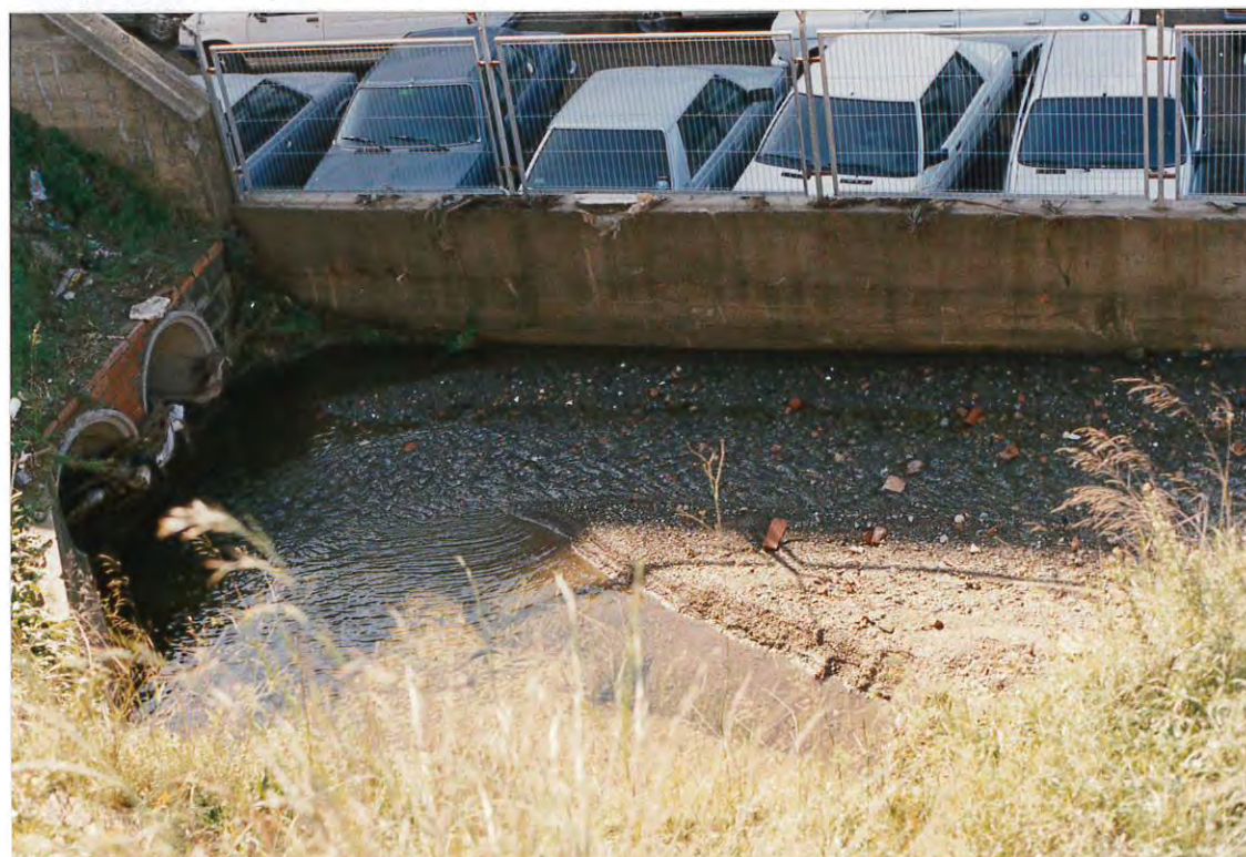
Figura 2. Colectores de paso del Torrent Tapioles a través del Polígono Industrial Can Cuyàs, parcialmente aterrados.
