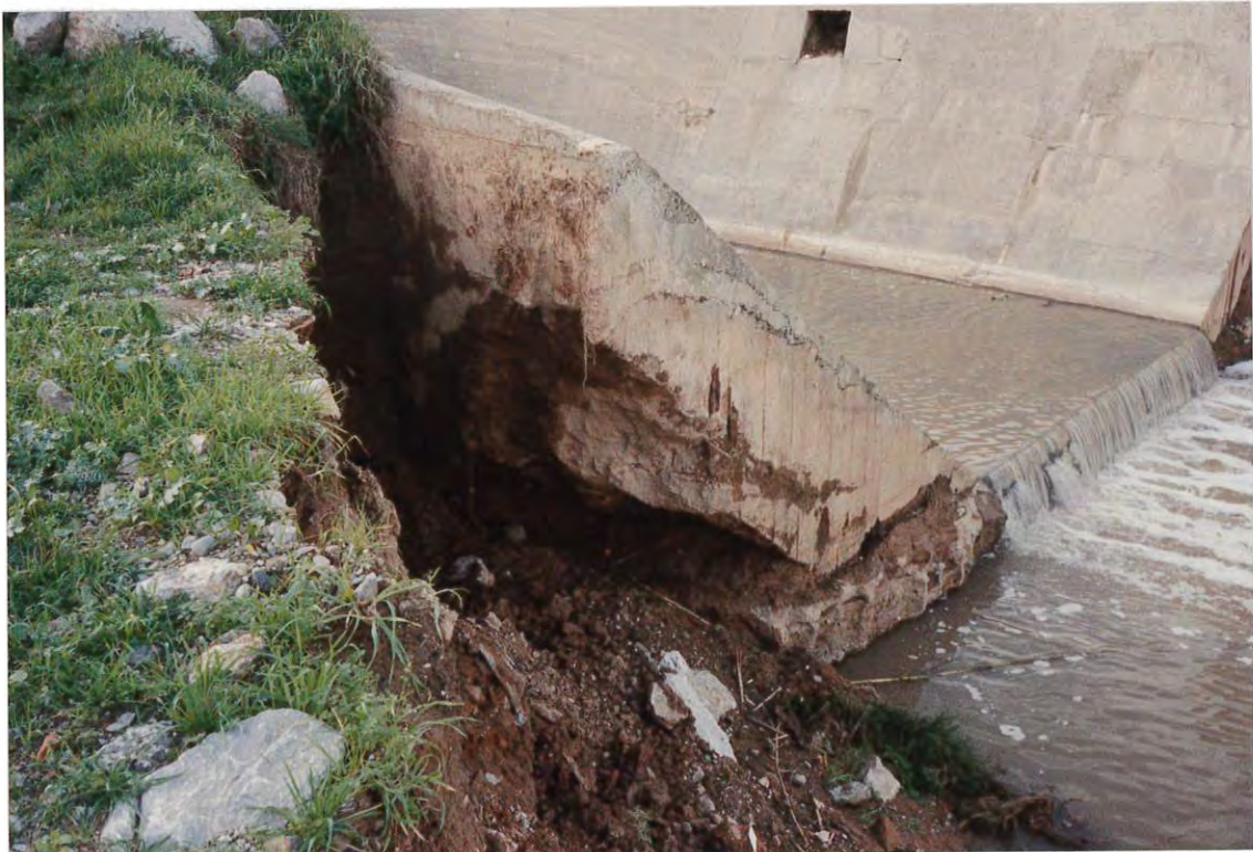
Figura 4. Descarnado del trasdós de la canalización de la riera, aguas abajo de las compuertas de protección.
