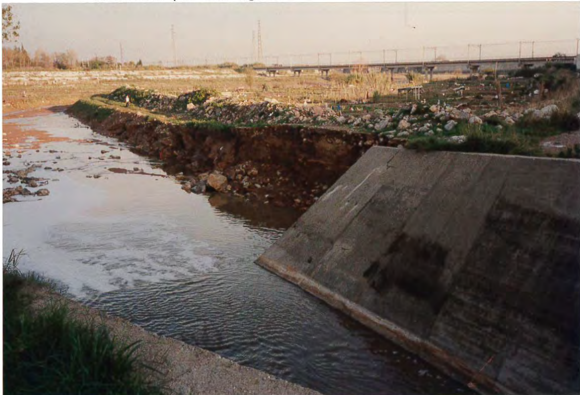
Figura 6. Vista del desprendimiento en la margen derecha, donde puede observarse el escaso nivel alcanzado por las aguas.
