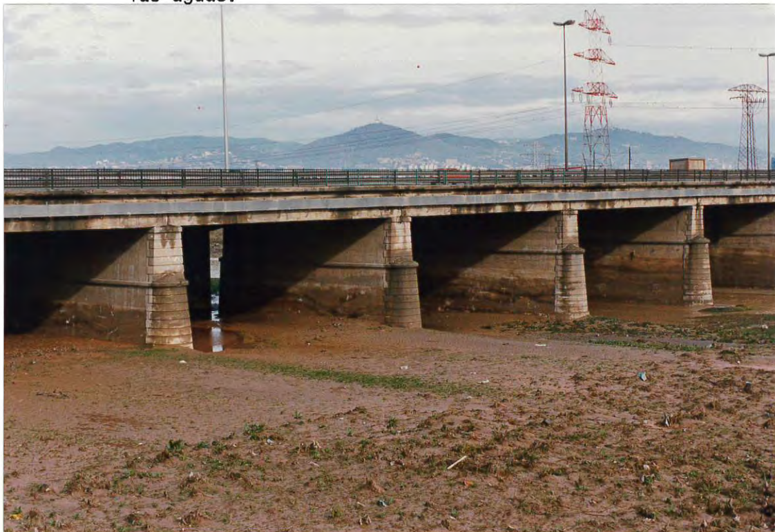
Figura 8. Puente antiguo de la Autovía de Castelldefels sobre el río Llobregat, donde puede observarse la marca dejada por el barro arrastrado por las aguas.
