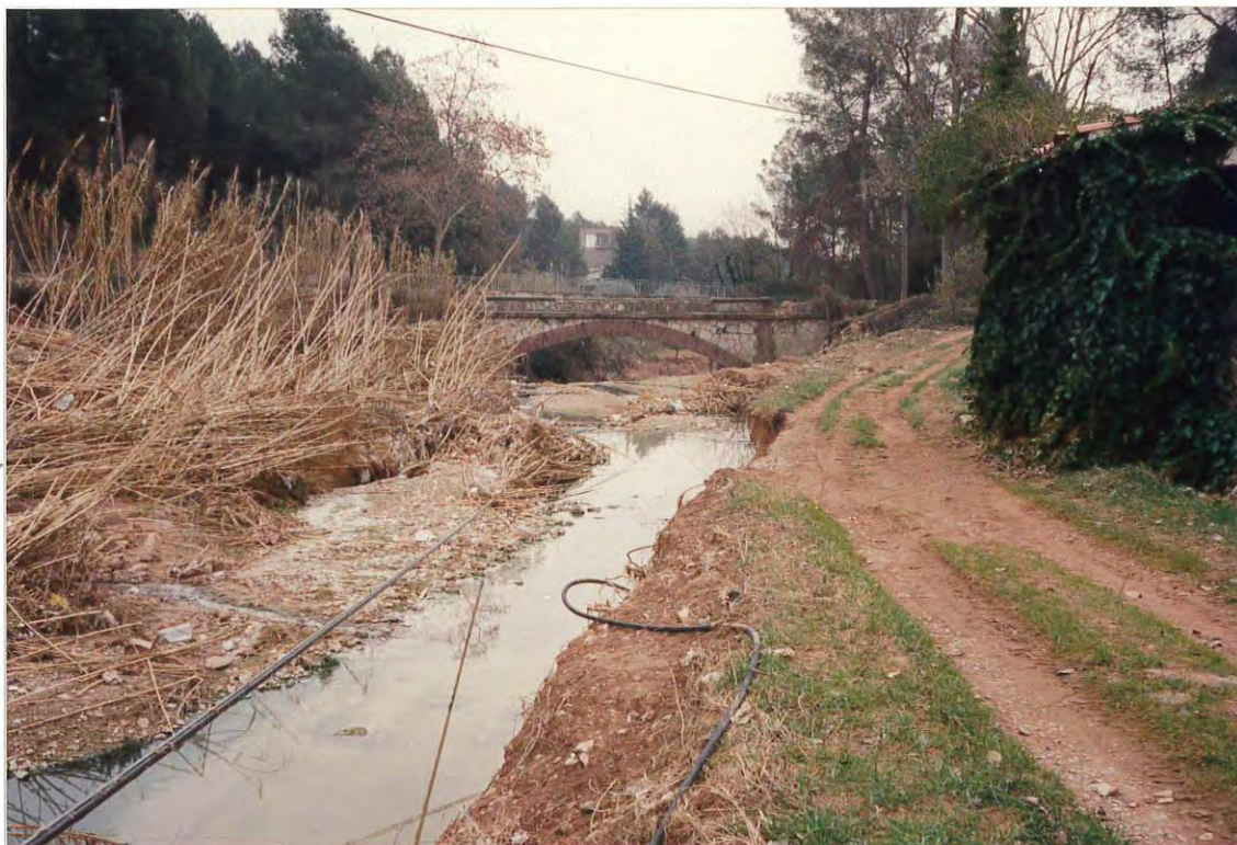
Figura 3. Erosión producida en el camino situado en el interior del cauce y destrozos de las conducciones de servicios.
