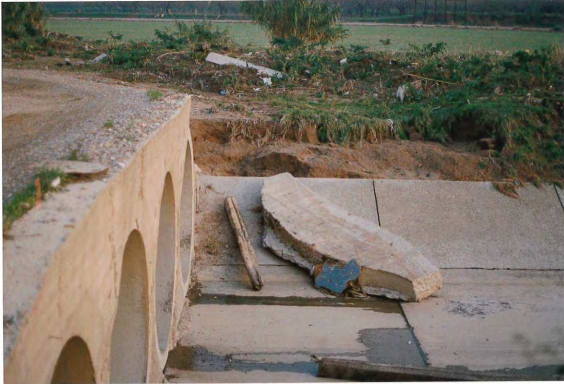
Figura 5. Erosión producida en el hastial izquierdo durante el retorno de las aguas al cauce del río.
