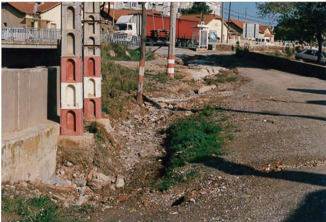
Figura 6. Destrozos producidos en una calle lateral a la riera de Sant Just.
