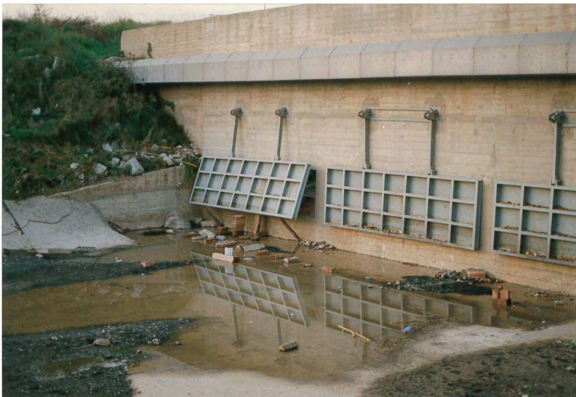
Figura 3. Compuertas antirretorno, vistas desde aguas abajo.
