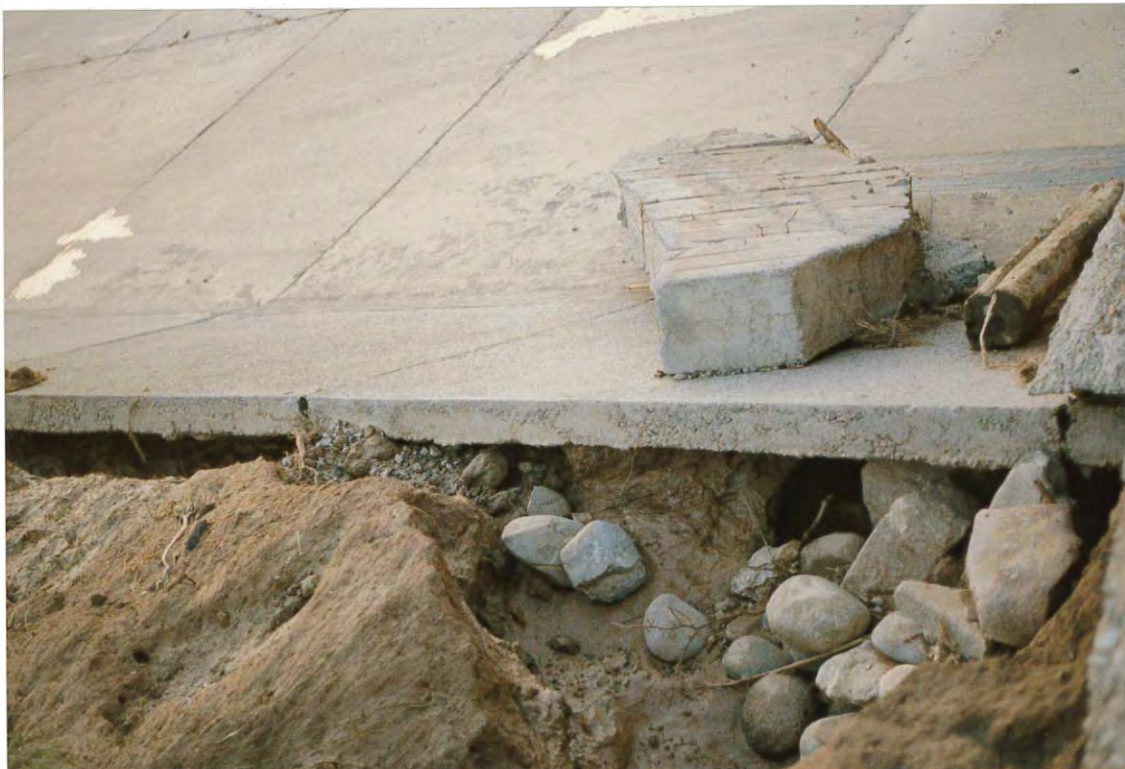
Figura 6. Detalle del descalce producido por el agua.
