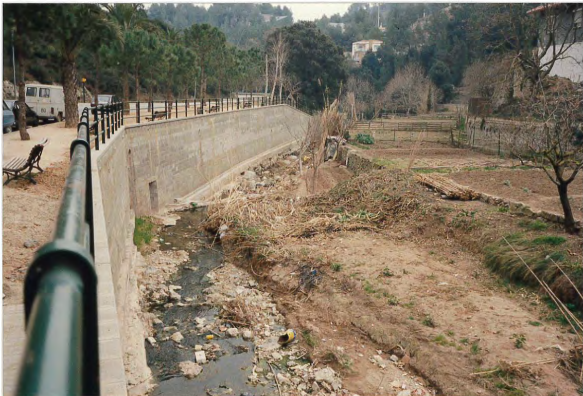
Figura 2. Nivel alcanzado por el agua en el muro de encauzamiento, similar al del muro inferior de la margen derecha.
