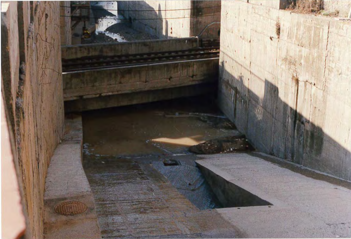
Figura 3. Cruce de la riera de Sant Just con el ferrocarril. Los arrastres impiden el correcto funcionamiento del rápido construido.
