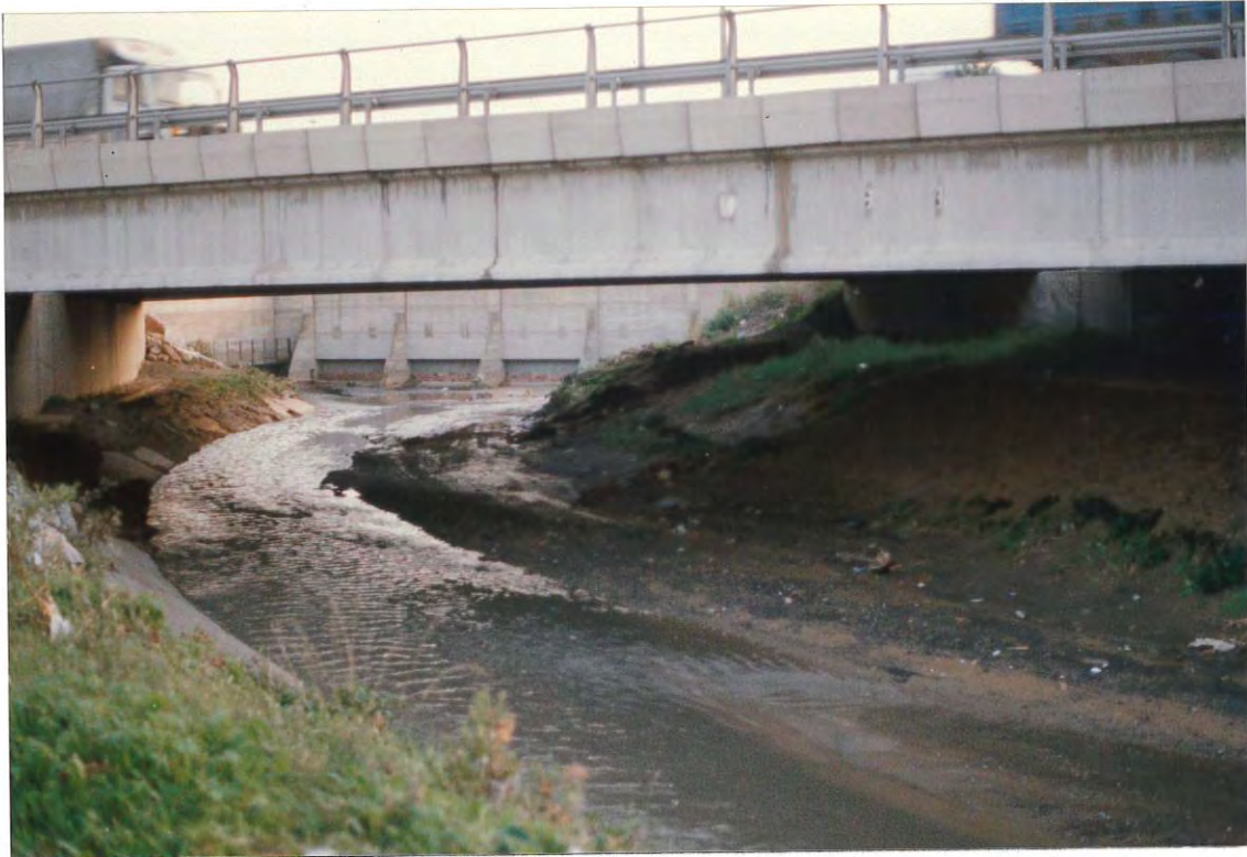
Figura 1. El canal de desagüe a su paso bajo el Cinturón Litoral, donde pueden apreciarse los arrastres acumulados de nuevo.
