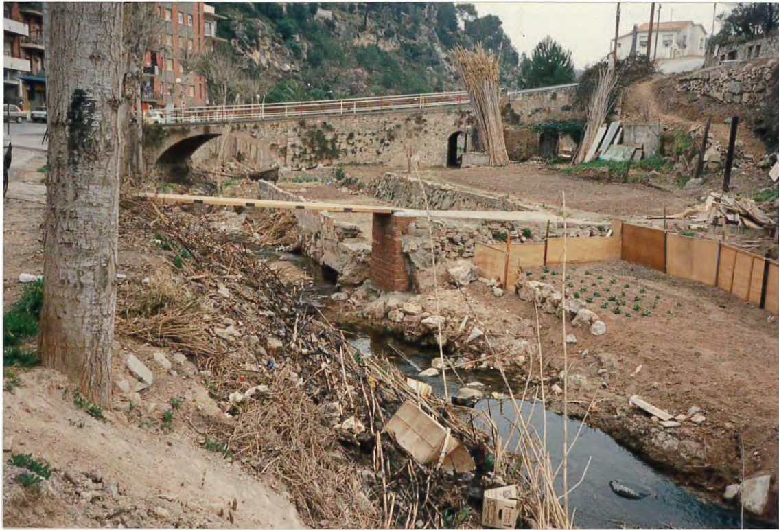
Figura 1. Estado del cauce de la riera de La Palma tras la avenida, con una pasarela reconstruida en primer término.
