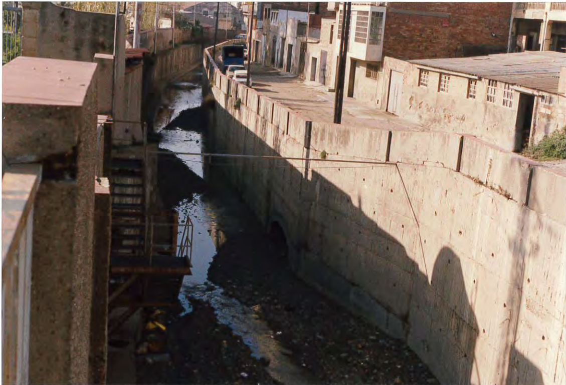
Figura 5. Arrastres acumulados en el cauce de la riera de Sant Just, aguas abajo del cruce con la vía del ferrocarril.
