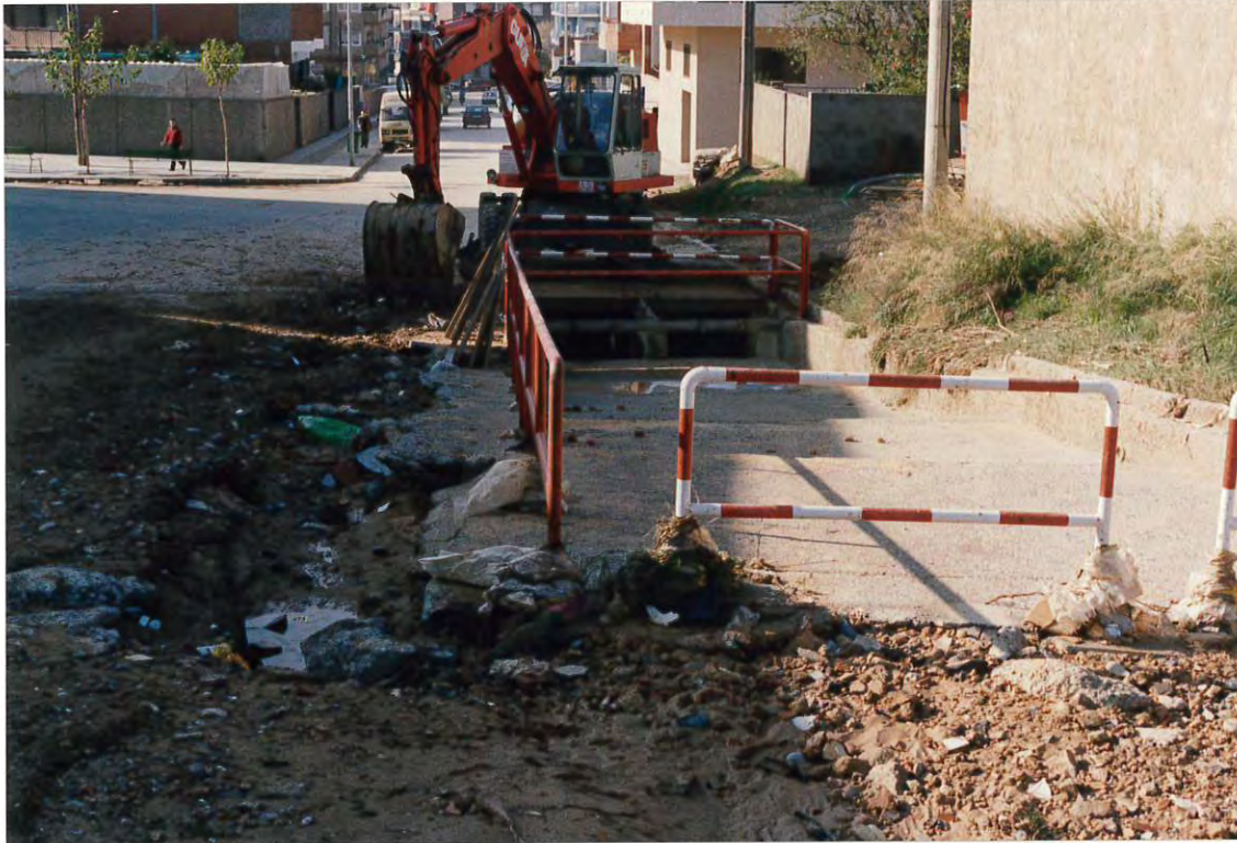
Figura 3. Embocadura de la canalización de la riera del Escorxador, donde se aprecia la altura alcanzada por el agua.
