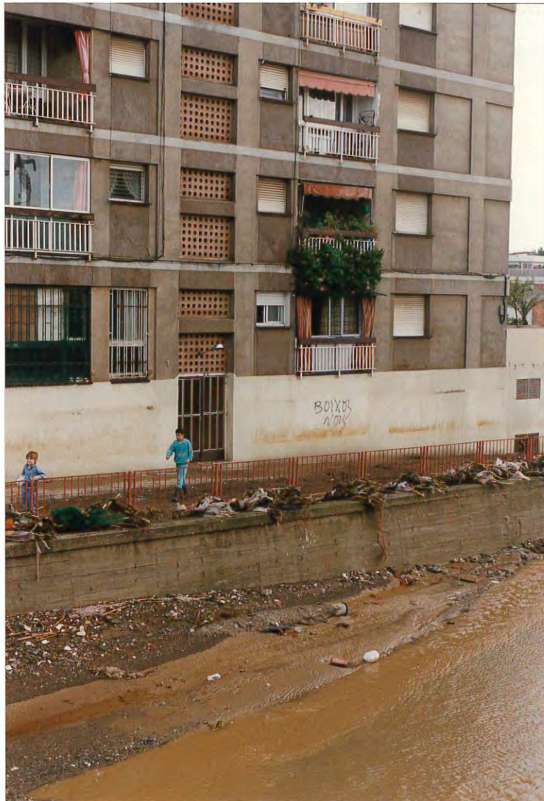
Figura 5. Señales dejadas por el agua en un edificio contiguo al cauce de la riera de Sant Climent.
