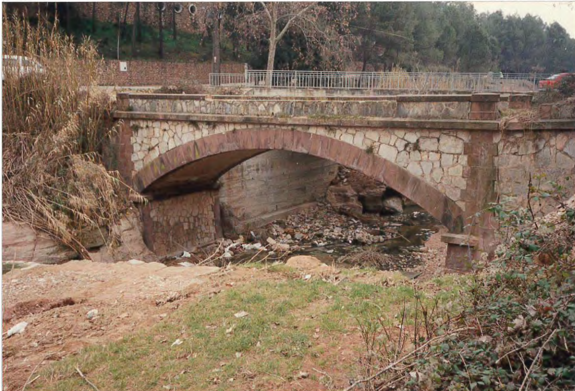
Figura 1. Puente de la carretera de Sant Vicenç dels Horts a Corbera de Llobregat, donde el agua alcanzó los \frac{2}{3} de su altura libre.
