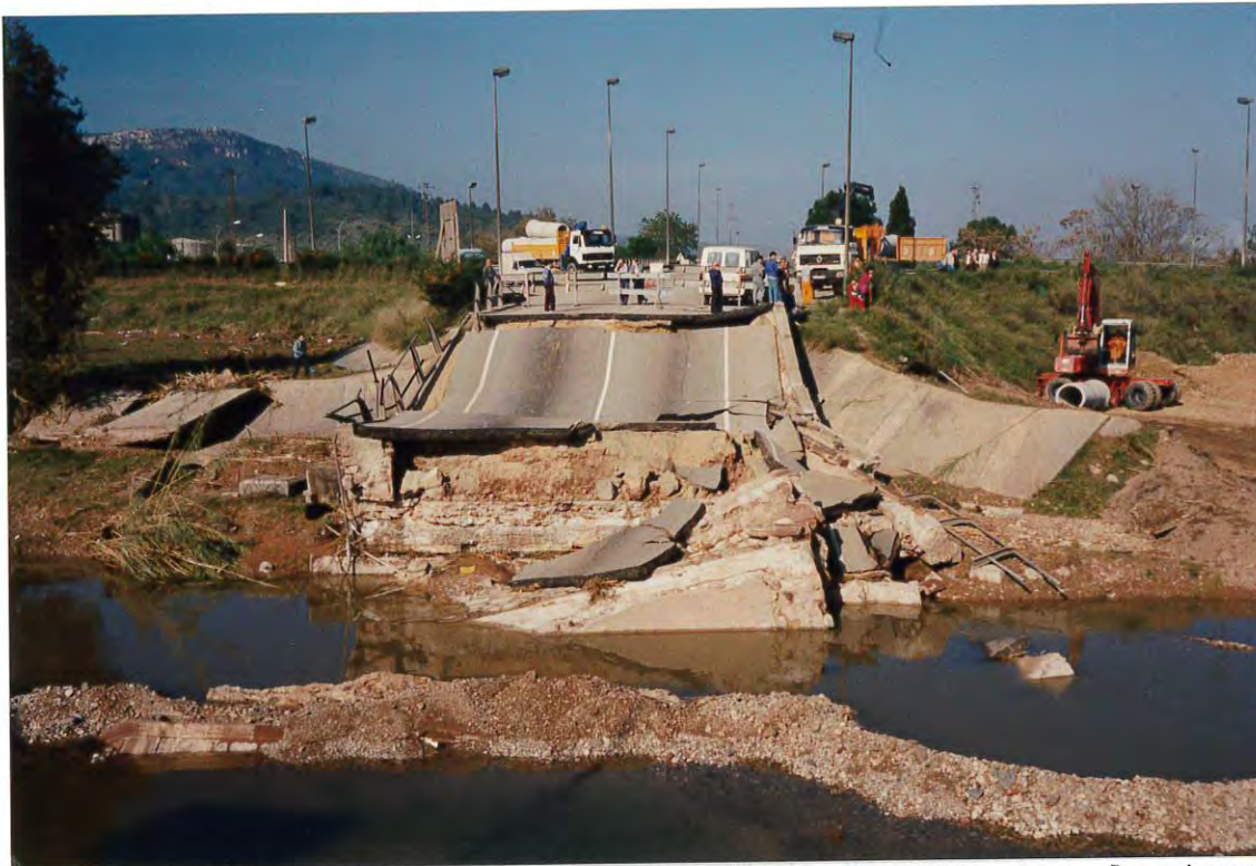
Figura 1. Estado del puente de la carretera BV-2002 sobre la riera de Cervelló tras la avenida del 12 de noviembre de 1988.
