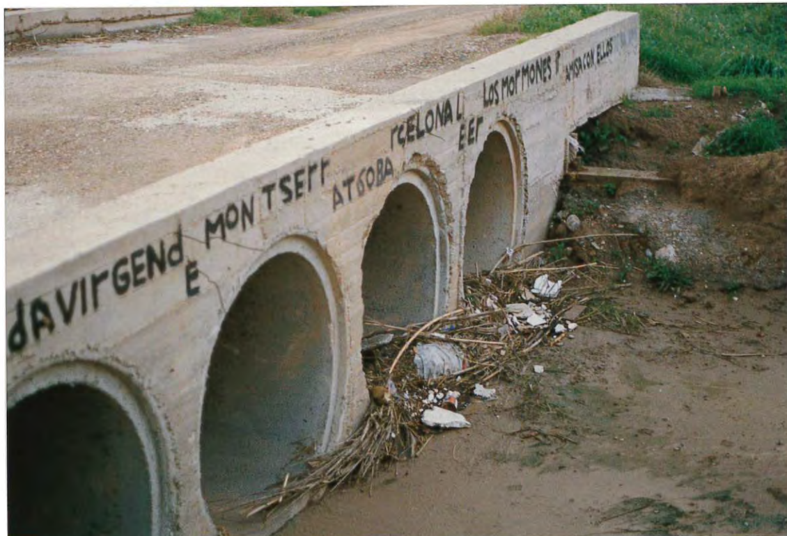
Figura 2. La riera d'en Nofre a su paso bajo un camino vecinal, donde se acumulan arrastres.
