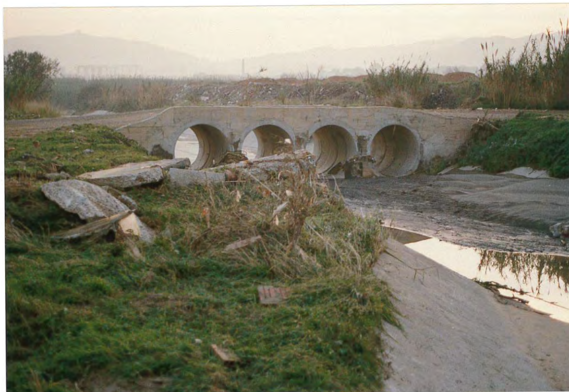
Figura 4. La reducción de la sección hidráulica que impone el paso de vehículos favorece la acumulación de arrastres.
