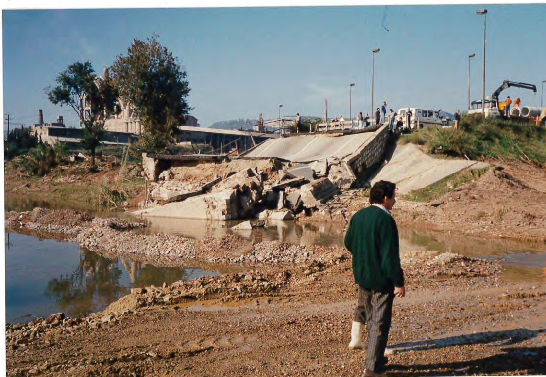
Figura 2. Vista de la pila izquierda del puente, totalmente destruída.
