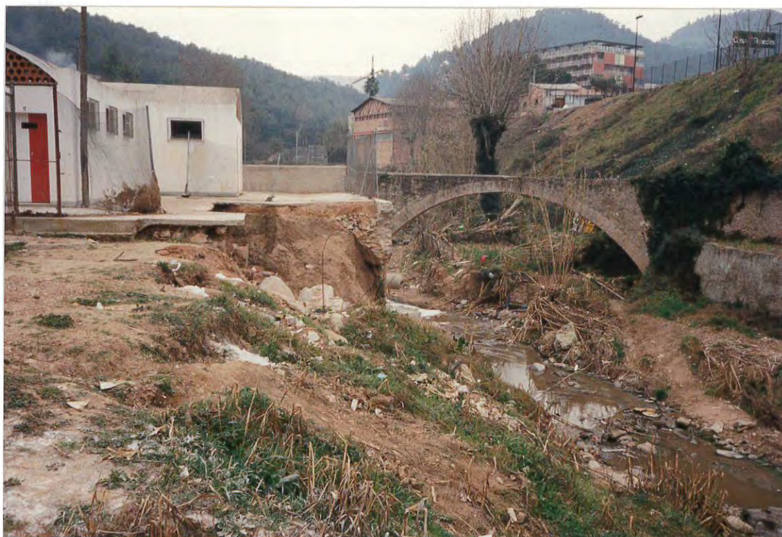
Figura 2. Zona de vestuarios de las instalaciones deportivas de la margen derecha, donde puede observarse el derrumbamiento producido por la erosión del agua.
