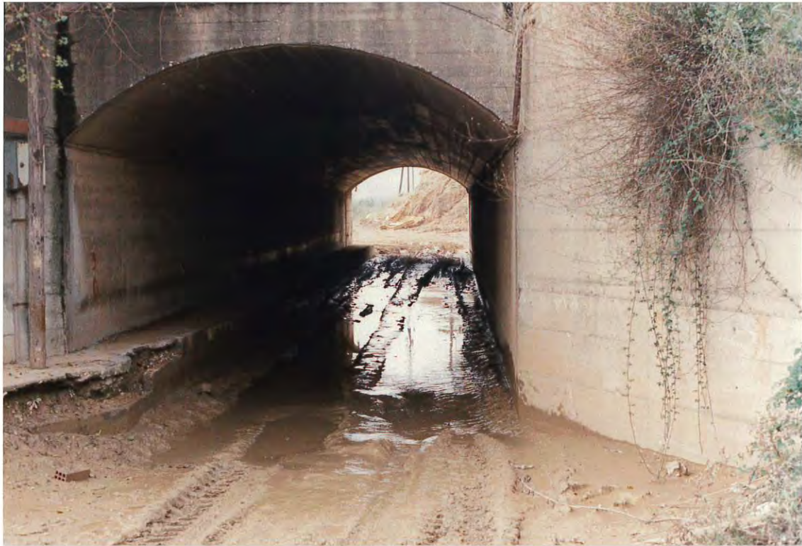
Figura 1. Paso bajo la autopista A-2 en el que se aprecia la falta de protección ante a una crecida del río.
