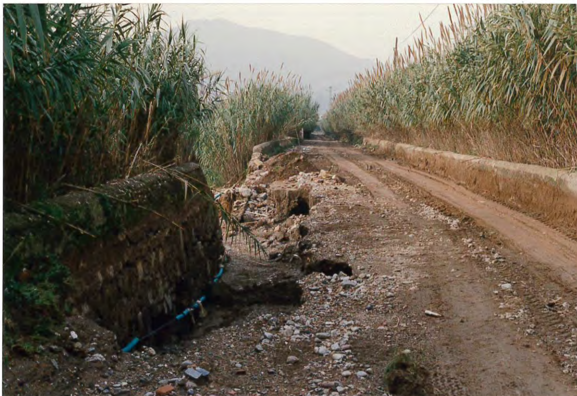
Figura 5. Desperfectos ocasionados en el hastial izquierdo. La diferencia de cota entre el lecho y el campo es de 1,5 m.
