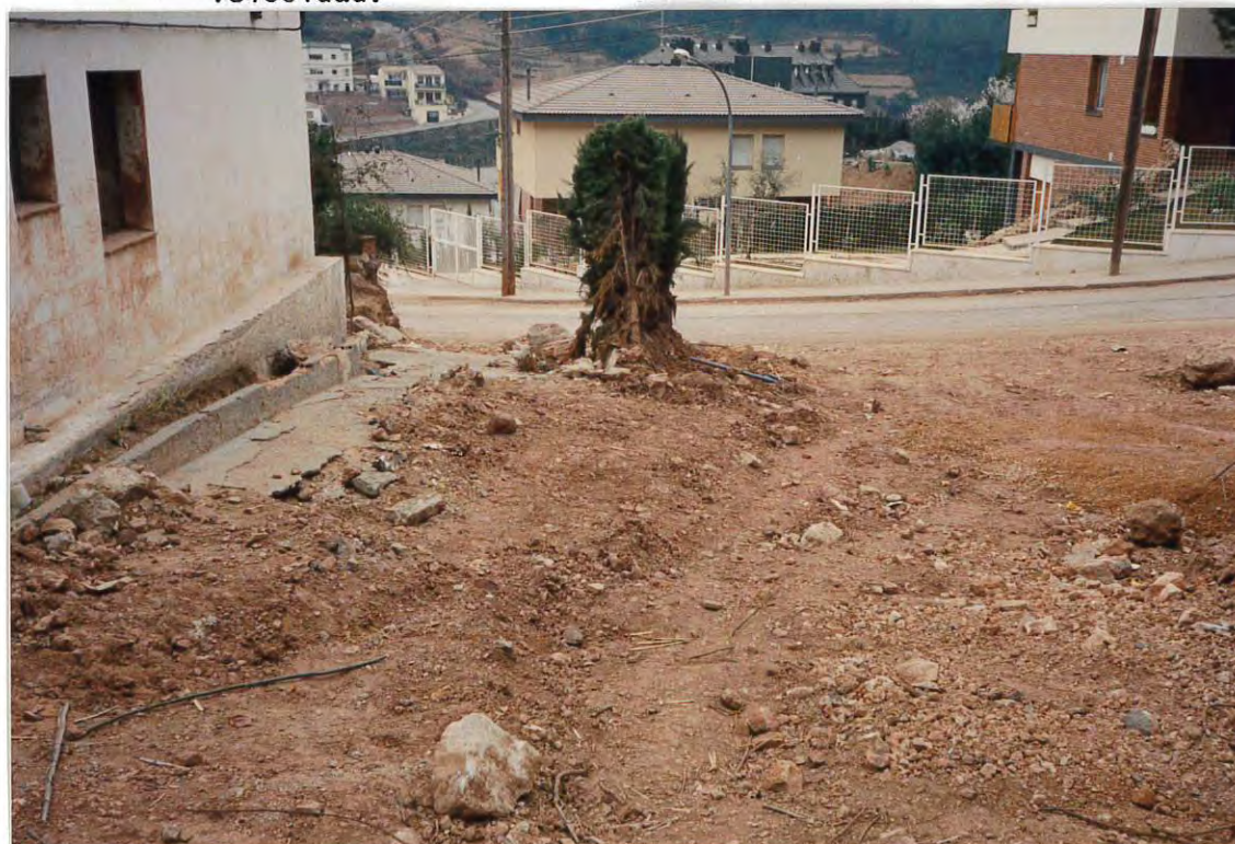
Figura 4. Desperfectos producidos por las aguas en la calle que ocupa el cauce de la riera.
