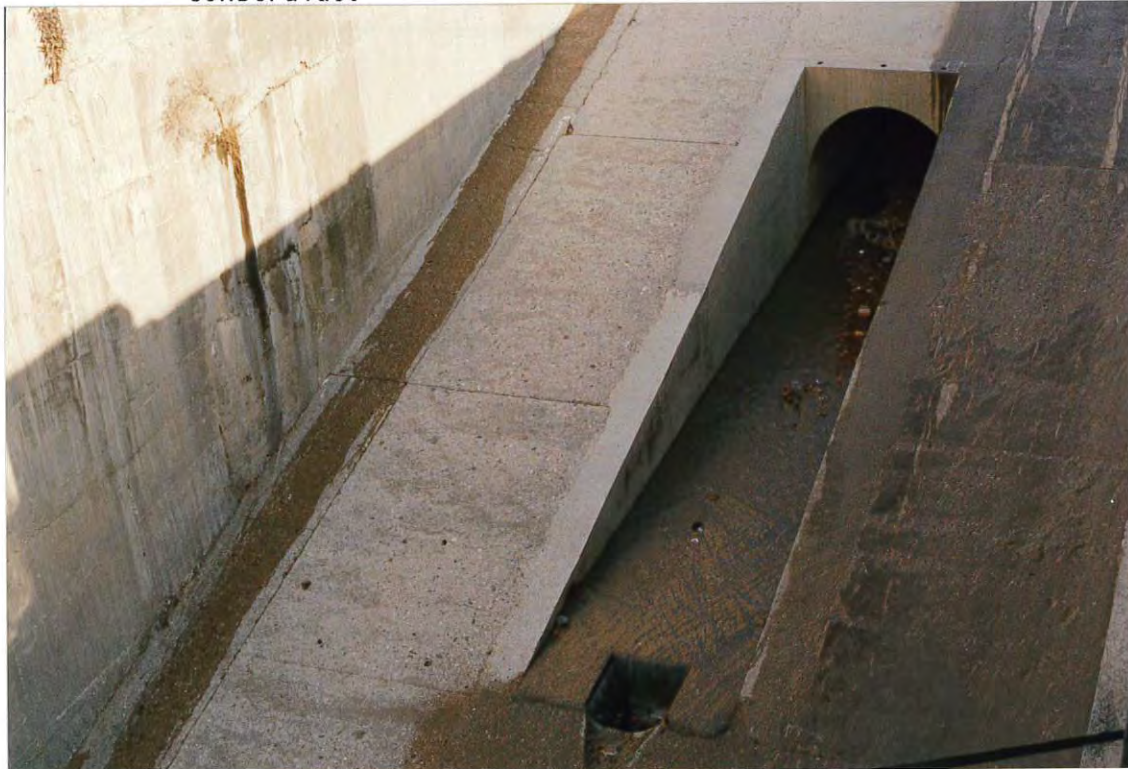
Figura 4. Detalle de los arrastres acumulados en el alcantarillado.
