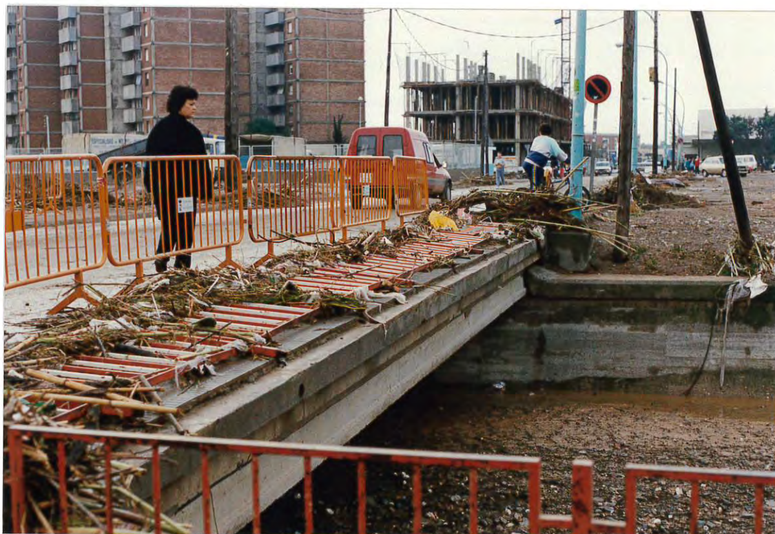
Figura 4. Desperfectos causados por la fuerza del agua en otro puente del casco urbano de Viladecans.
