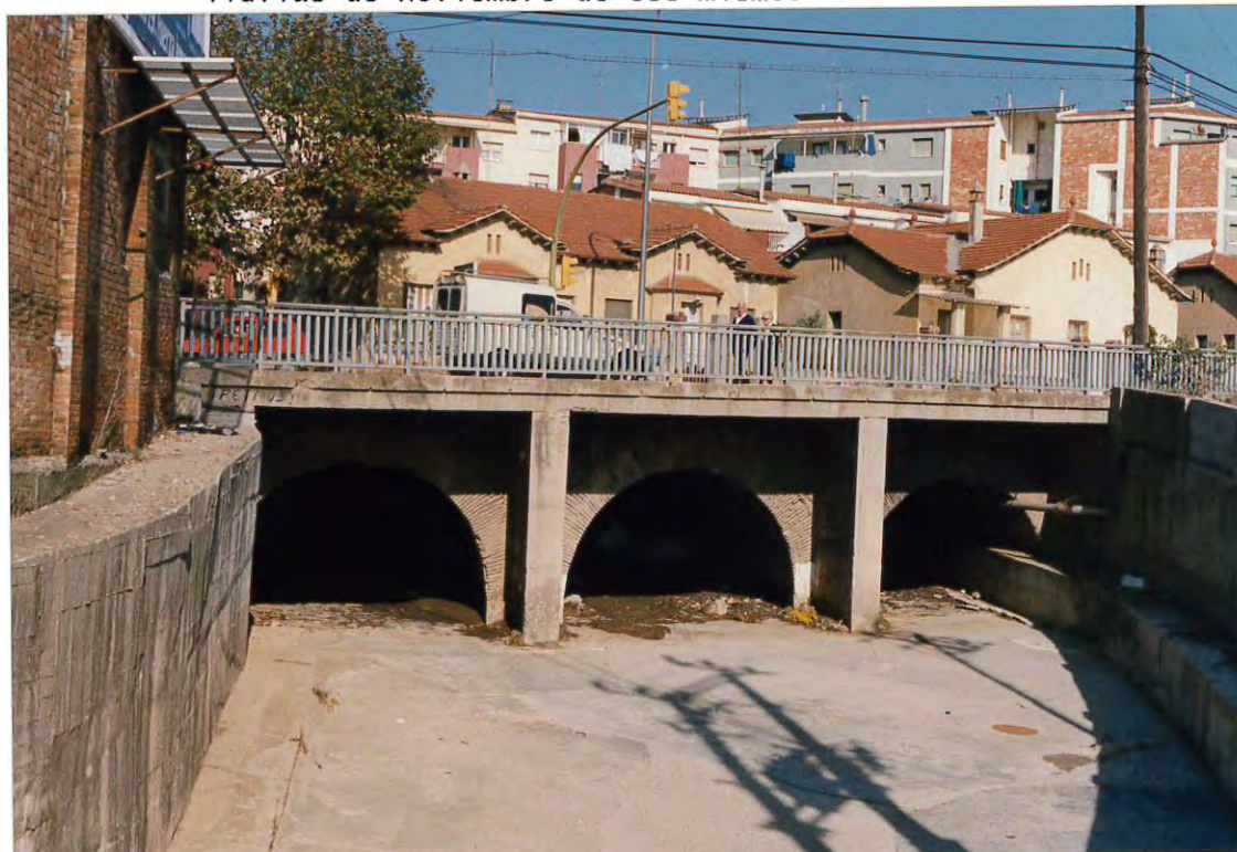
Figura 2. Cauce de la riera de Sant Just a su paso bajo el puente de la carretera N-II, donde pueden apreciarse los arrastres acumulados.
