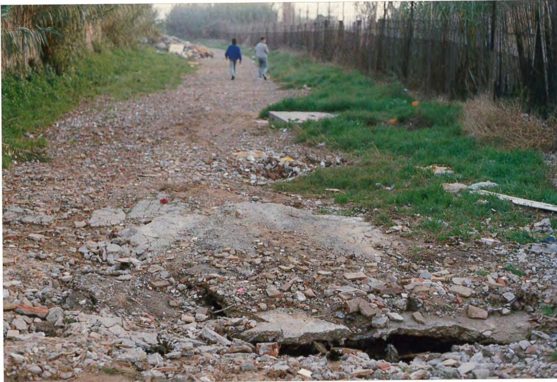
Figura 1. Desperfectos sufridos en el lecho de la riera de Fonsanta.
