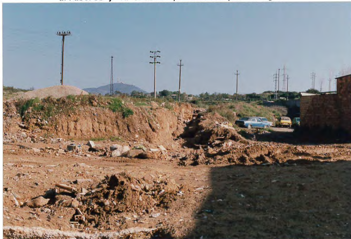
Figura 2. Apertura del cauce de la riera del Escorxador realizada en septiembre de 1988 que evitó la inundación de las fábricas colindantes.
