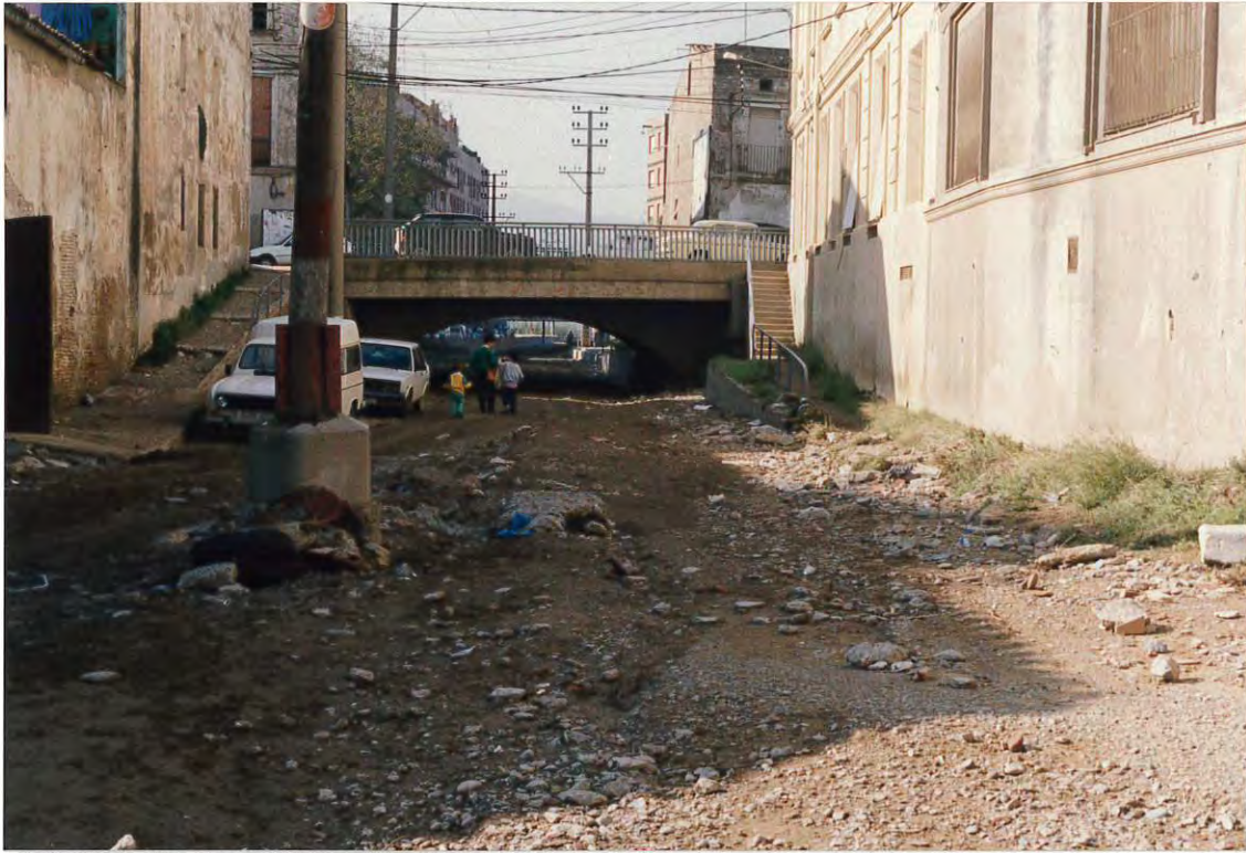
Figura 3. La riera de la Salut a su paso bajo el puente de la carretera N-II, donde se aprecian los arrastres, la erosión y la altura alcanzada por el agua (1,20 m).
