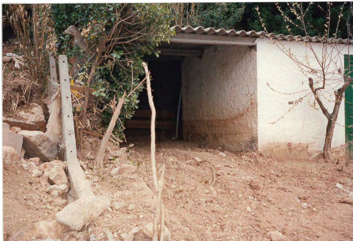
Figura 2. Altura alcanzada por el agua en una construcción situada junto al cauce de la riera.
