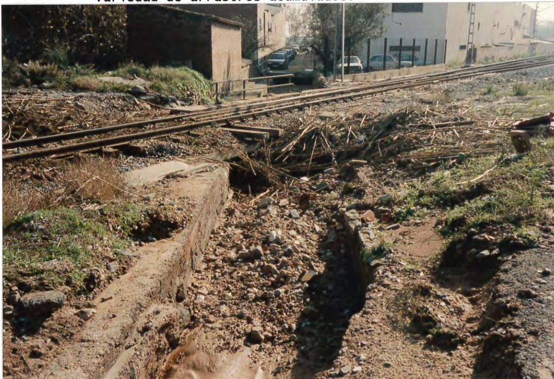
Figura 2. Entrada de la riera de Can Lluc bajo el puente de los Ferrocarriles de la Generalidad, desde donde puede observarse la limpieza del tramo de cauce aguas abajo.
