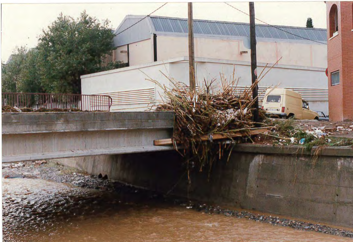
Figura 1. Arrastres acumulados por la riera de Sant Climent en un puente del casco urbano de Viladecans.
