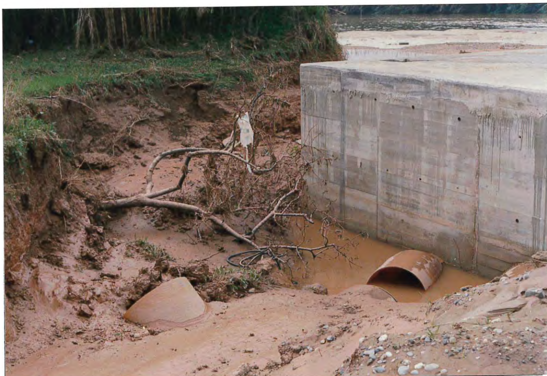
Figura 4. Erosión causada por la vuelta de las aguas al río. Al fondo el río Llobregat, sin un margen consolidado.
