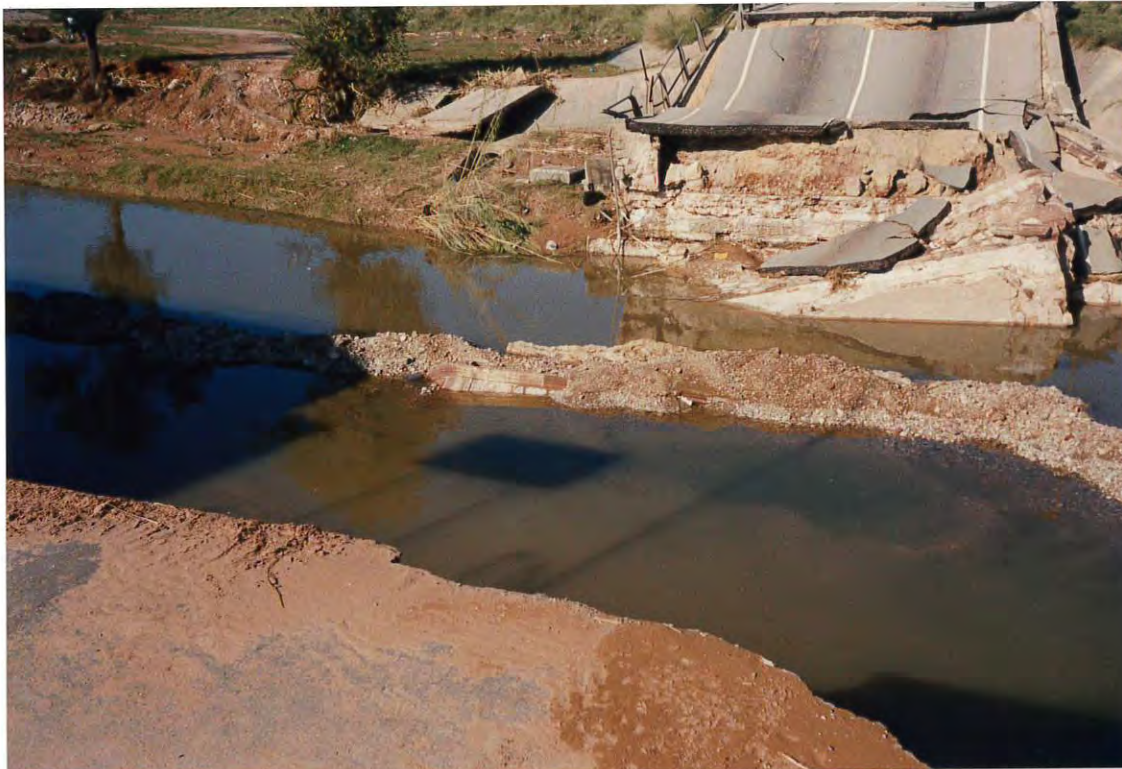
Figura 3. La pila derecha del puente, volcada y hundida, aparentemente en buen estado.
