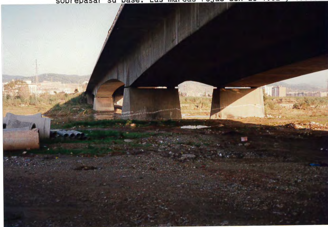
Figura 6. Vista general del puente anterior. La pila izquierda muestra el nivel máximo del agua, que no llegó a sobrepasar la zona desde donde se realizó la fotografía.
