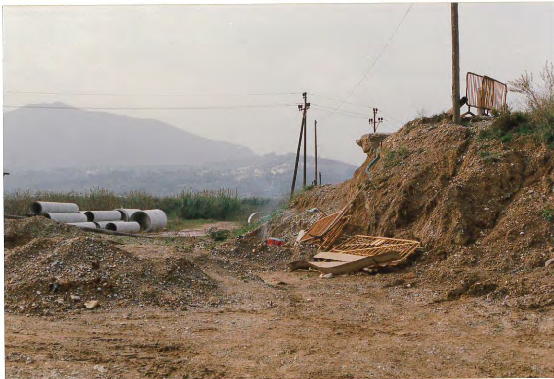
Figura 2. Los trabajos de construcción de un colector obligaron a derribar la protección contra las crecidas.
