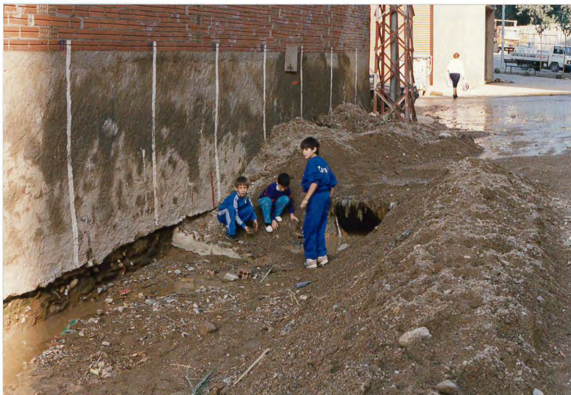
Figura 2. Arrastres y deterioro del cauce de la riera de la Salut. El desagüe de la calle Sagrument quedó nuevamente derruido.
