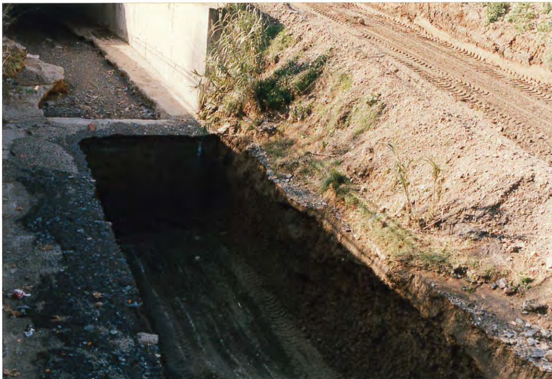
Figura 1. Dispositivo de retención de sólidos construido en agosto de 1988, completamente aterrado durante el episodio de lluvias de noviembre de ese mismo.
