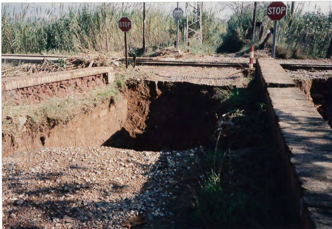
Figura 2. Socavón producido por el agua en el camino de acceso a la riera de Can Solé, entre la carretera BV-2002 y el ferrocarril.
