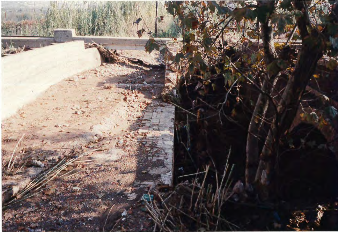
Figura 1. Muro de la riera de Can Solé roto por la fuerza del agua.
