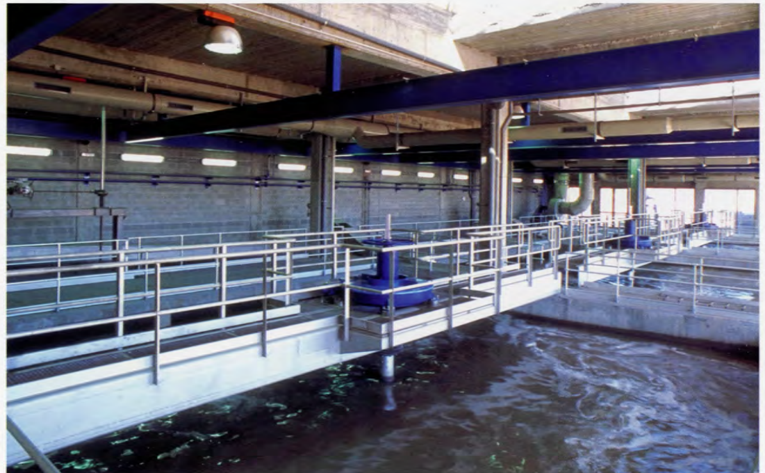
Tratamiento preliminar y desarenado
