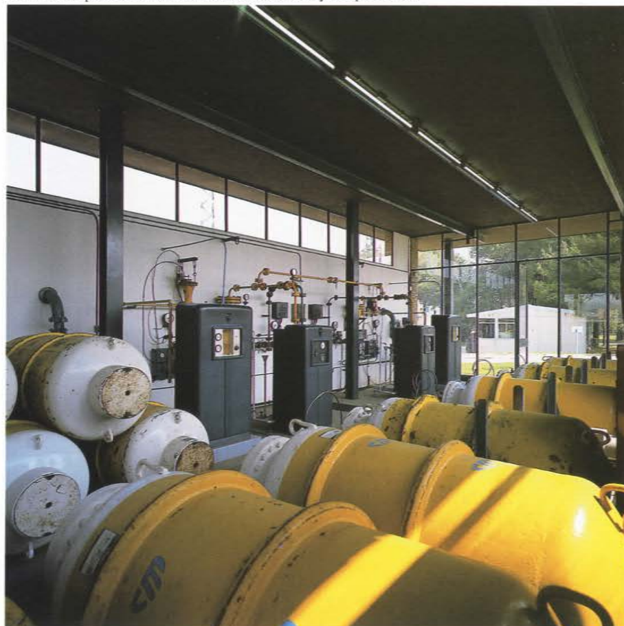
Instalación para dosificar el cloro. Cloradores y evaporadores
