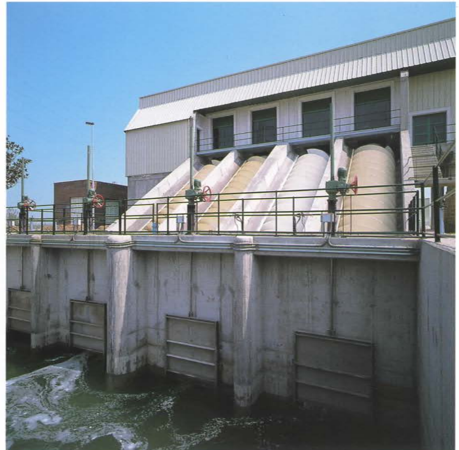
Bombeo intermedio. Tornillos de Arquímedes
