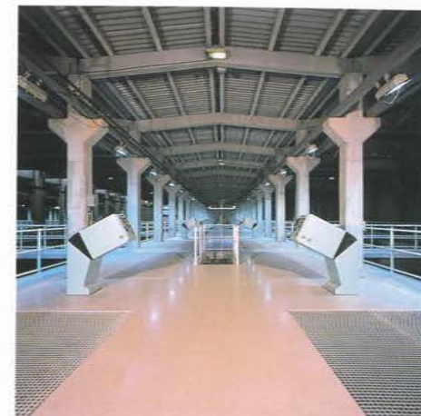
Galería de mando de los filtros de carbón activo
