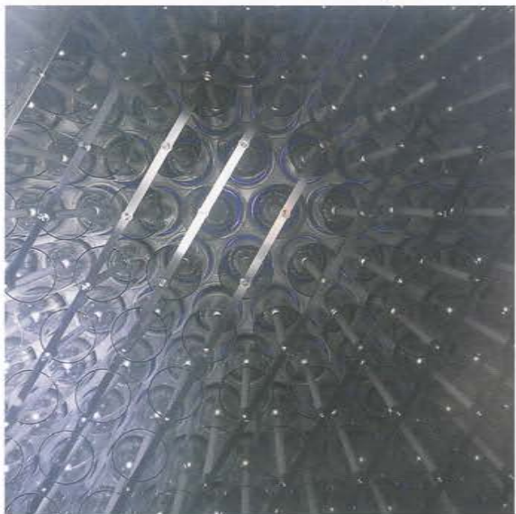
Vista de los dialéctricos en el interior del aparato ozonizador
