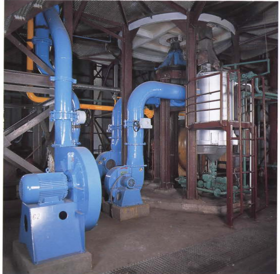
Detalle de los ventiladores de aire de combustión y de refrigeración del eje
