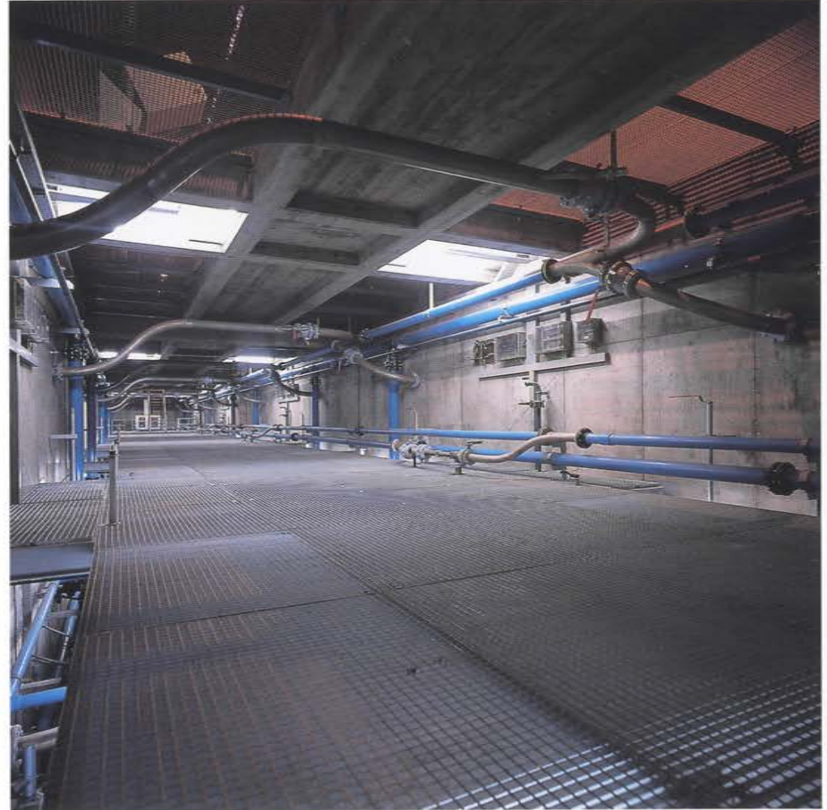
Galerías de servicio de los filtros de carbón activo
