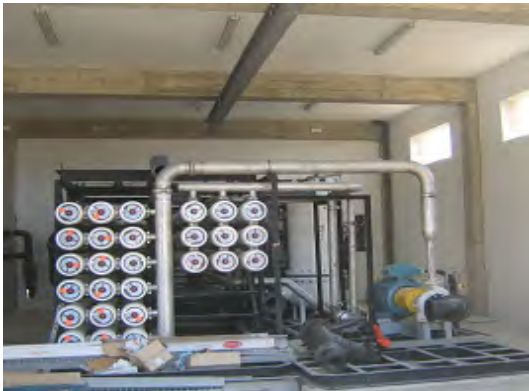
Ampliació de la 2a línia a la planta d'osmosi inversa Mas Blau
