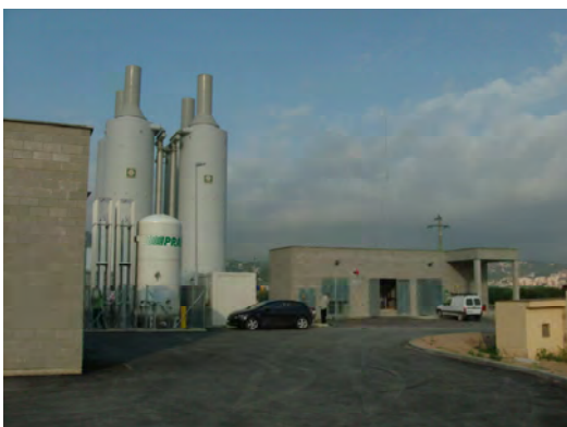
Planta de Stripping dels pous Estrella de Sant Feliu
