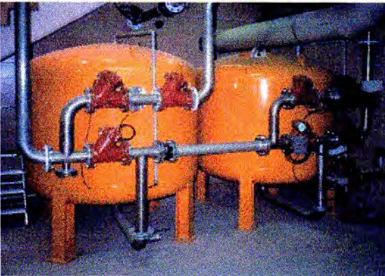
Figura 2. Filtres tancats multicapa Culligan instal·lats a les EDAR de la Zona Nord de la Costa Brava.
