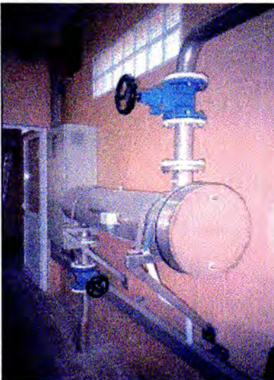
Figura 3. Equips de desinfecció UV instal·lats a les EDAR de la Zona Nord de la Costa Brava.
