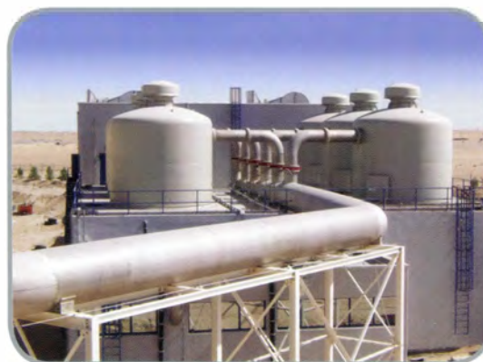
المرحلة الخامسة Chlorination Dosing Room
