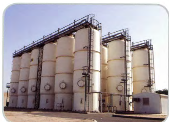
خزانات التعويض على خطوط النقل Surge Vessels
