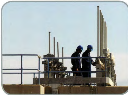
مبنى التحكم بالتدفق Flow Control Chamber
