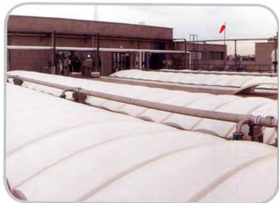
إزالة الرمال والزيوت Sand & Grease Traps at Ardiya
