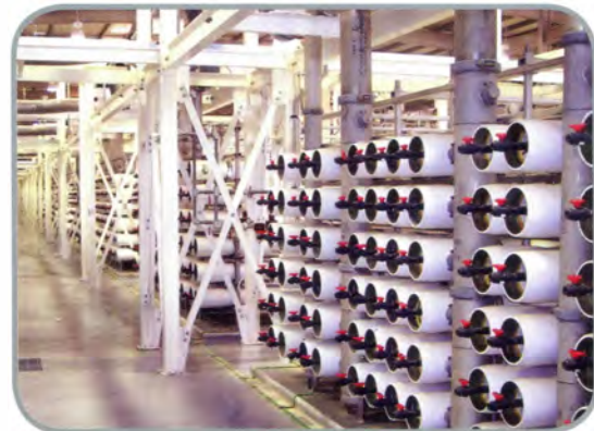
المرحلة الرابعة Reverse Osmosis Building
