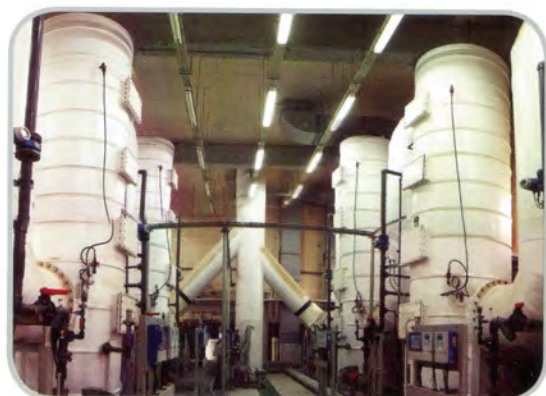
مبنى معالجة الروائح Odor Control Building
