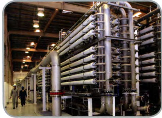
المرحلة الثانية Ultra - Filtration Building
