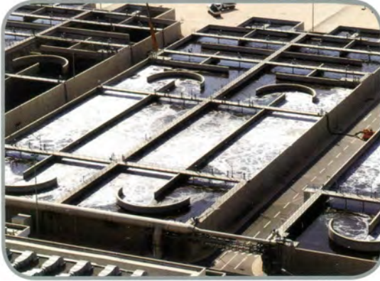
أحواض التهوية Aeration Tanks
